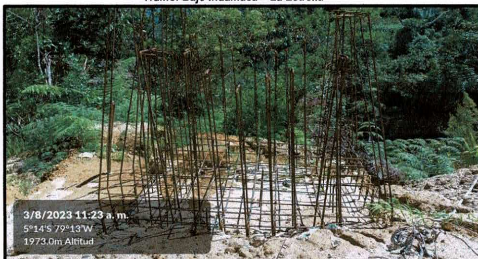
Imagen n.º 20 Aceros de las cajas receptoras oxidando Tramo: Bajo Ihuamaca – La Estrella
