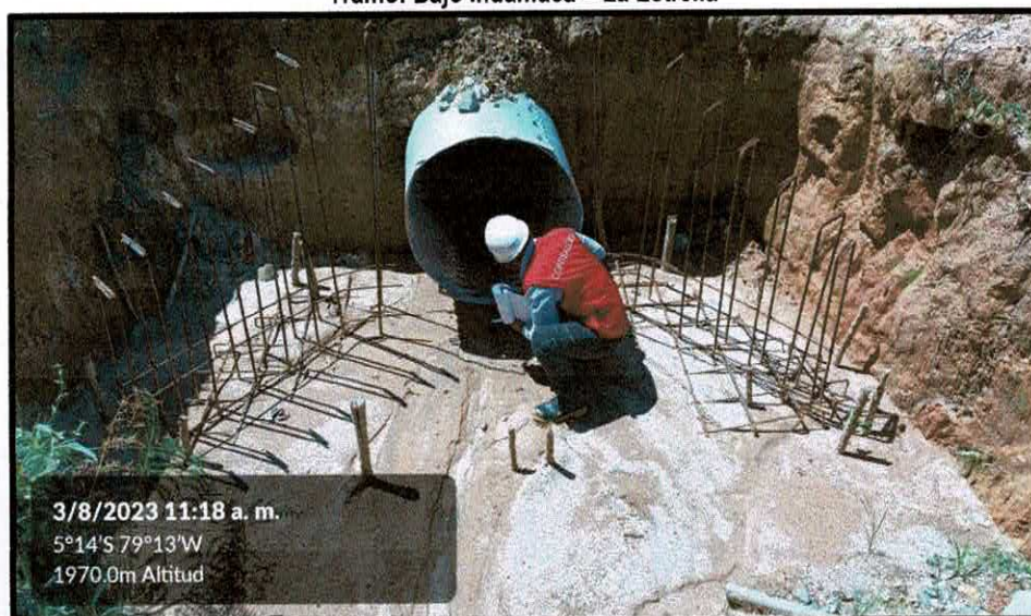
Imagen n.º 19 Aceros de las aletas de concreto de los cabezales de salida oxidando Tramo: Bajo Ihuamaca – La Estrella
