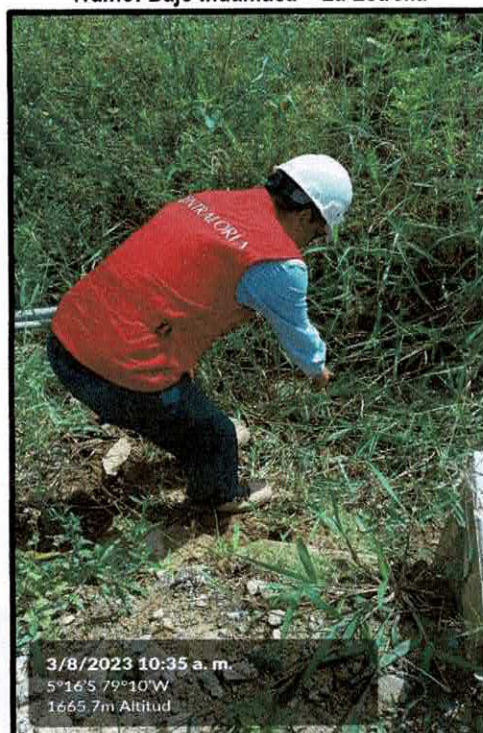
Imagen n.º 21 Emboquillado de piedra de concreto del cabezal de salida sin ejecutar Tramo: Bajo Ihuamaca – La Estrella
