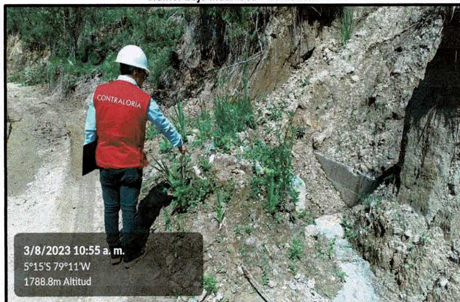
Imagen n.º 16 Vista de las cajas receptoras cubierto de barro Tramo: Bajo Ihuamaca – La Estrella
