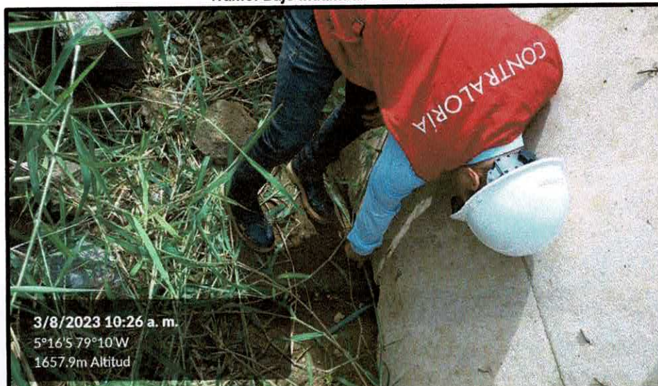
Imagen n.º 15 Colmatación de las alcantarillas TMC Ø 36" en la toma de ingreso y salida Tramo: Bajo Ihuamaca – La Estrella
