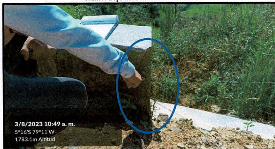
Imagen n.º 14 Daños de la pantalla del cabezal de salida Tramo: Bajo Ihuamaca – La Estrella
