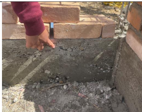
Fotografía n.º 39: Se observó presencia de cangrejas en sobrecimientos de UBS N° 172, asimismo éstos tienen una altura de 28cm.
