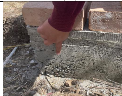
Fotografía n.º 40: Se observó presencia de cangrejas en sobrecimientos de UBS N° 172, asimismo éstos tienen una altura de 28cm.
