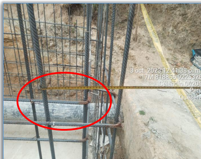
Fotografía n.º3 Separación de 27 cm en el acero vertical.
