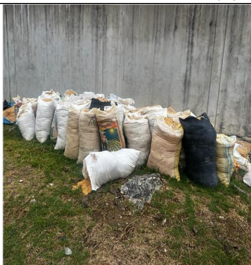
Fotografía n.º1 Se aprecia sacos de agregado fino que se han acumulado en la parte externa del presedimentador.
