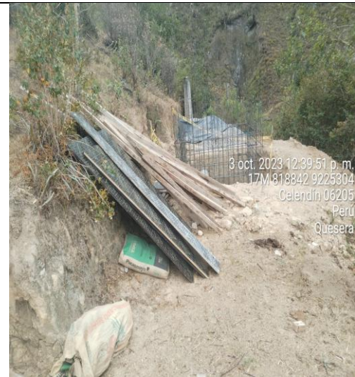
Fotografía n.º 4: Se evidencia paneles de encofrado cerca de estructuras hidráulicas.
