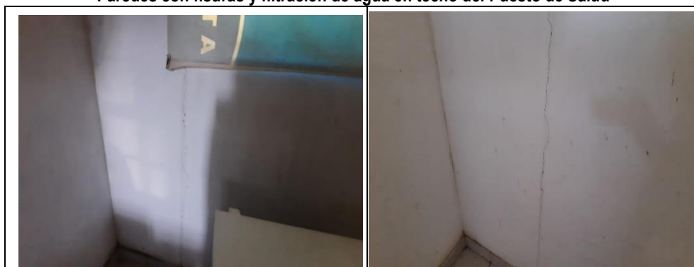
Fotografías n.ºs 11, 12, 13 y 14 Paredes con fisuras y filtración de agua en techo del Puesto de Salud
