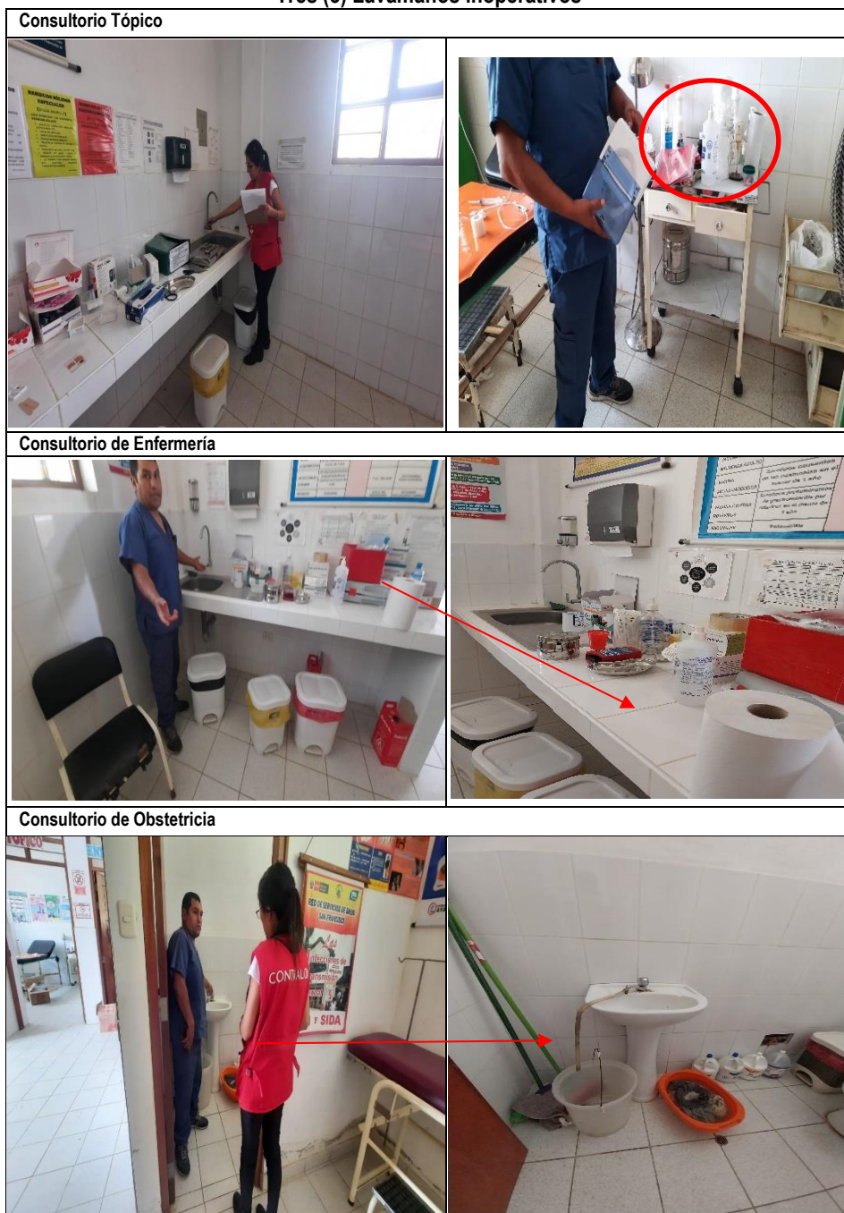
Fotografías n.ºs 22, 23, 24, 25, 26 y 27 Tres (3) Lavamanos inoperativos
