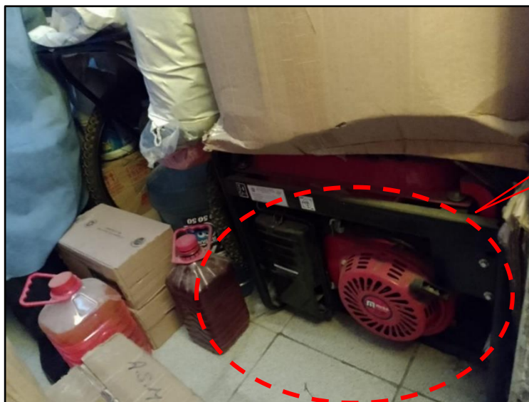
Imagen n.º 7 Grupo electrógeno inoperativo
