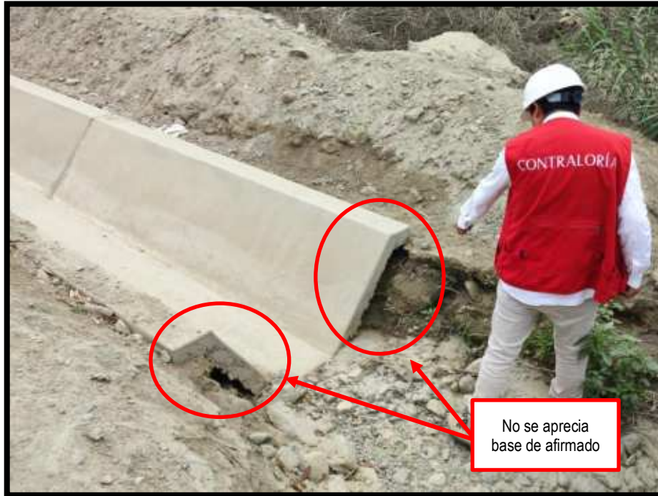
IMAGEN N° 12 CANAL DE CONCRETO SIN BASE DE AFIRMADO MARGEN IZQUIERDO EN CAMBIO DE LADO DE LA VÍA
