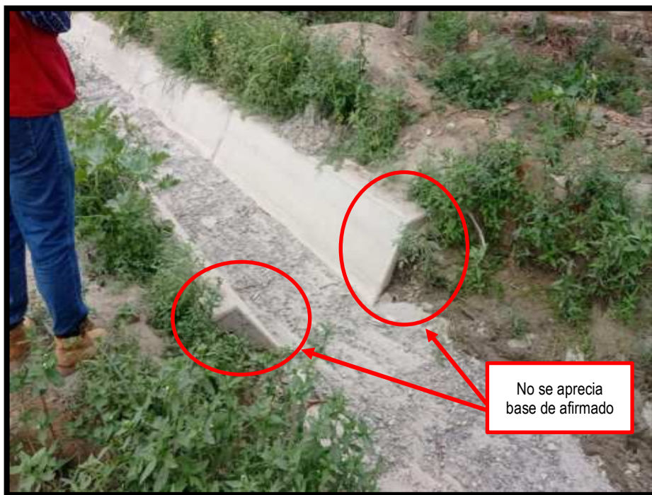
IMAGEN N° 13 CANAL DE CONCRETO SIN BASE DE AFIRMADO MARGEN DERECHO EN CAMBIO DE LADO DE LA VÍA
