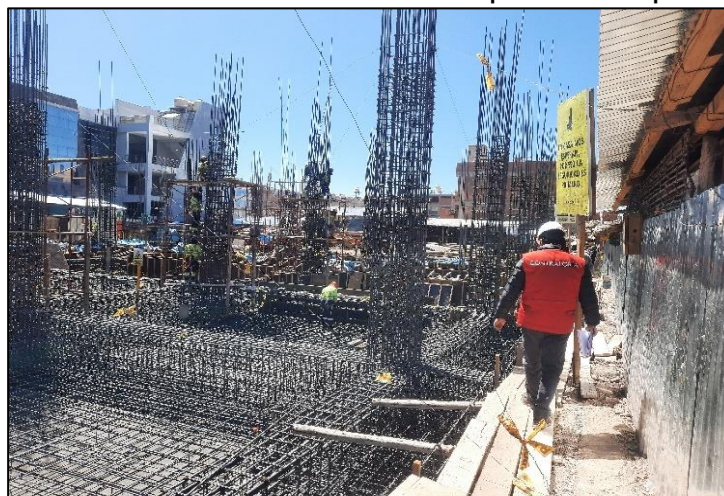
Imagen n.º 8 Camineras no cuentan con anchos suficientes para el tránsito peatonal
