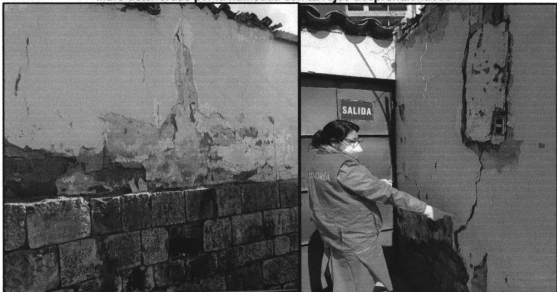
Imagen n.º 7 Muro deteriorado por la humedad con tarrajeo desprendiéndose
