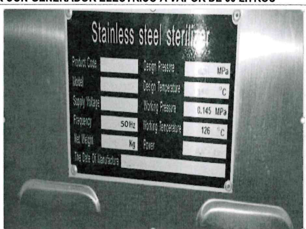
Fotografía n.º 6: Se puede apreciar que la placa de los valores de frecuencia es de 50 Hz que no es compatible con la frecuencia de trabajo en el Perú según el Código Nacional de Electricidad, aprobado mediante Resolución Ministerial n.º 037-2006-MEM-DM de 17 de enero de 2006.
