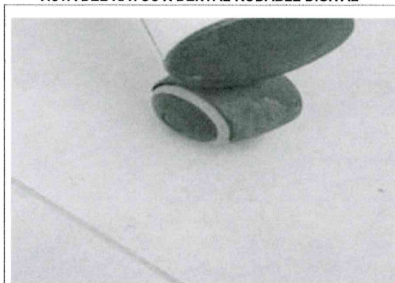
Fotografía n.° 4: Vista de la garrucha sin el respectivo dispositivo de frenado
