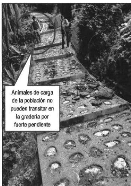
Tramo Paloma Huachanan: Se observó a un poblador transitando por el borde de la gradería; toda vez que, su animal de carga no puede transitar por las mismas, debido a la pendiente fuerte.
