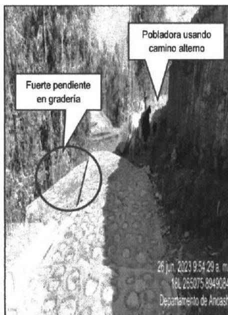
Tramo Pac - Pac: Se observó a una pobladora transitando por un camino alternativo; toda vez que, el animal de carga no puede transitar por las graderías de piedra con concreto, debido a la pendiente fuerte.
