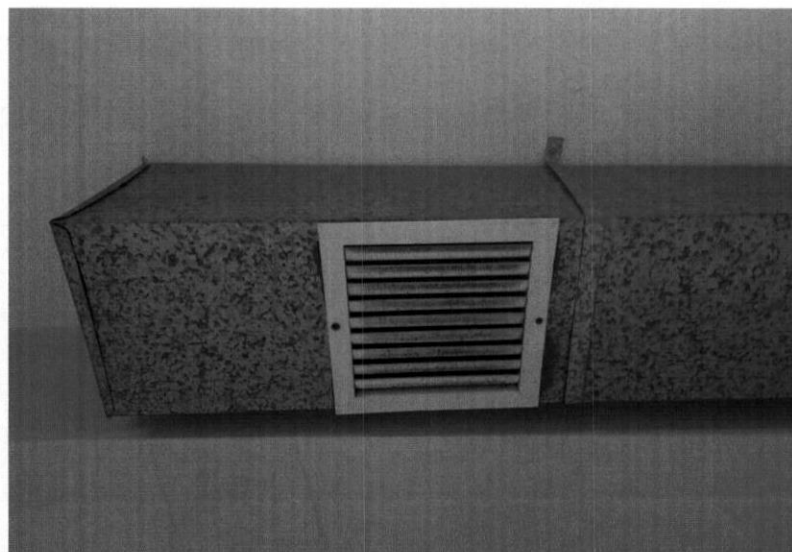
Presencia de polvo en la rejilla del sistema de extracción de aire viciado instalado en el techo de la sala de necropsias de la Entidad.
