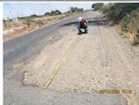
Desprendimiento de Slurry Seal en la progresiva 1+630.
