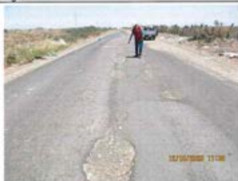
Desprendimiento de Slurry Seal en ambos carriles en la progresiva 0+500.
