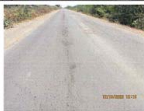
Desprendimiento de Slurry Seal en ambos carriles de la progresiva 7+200.
