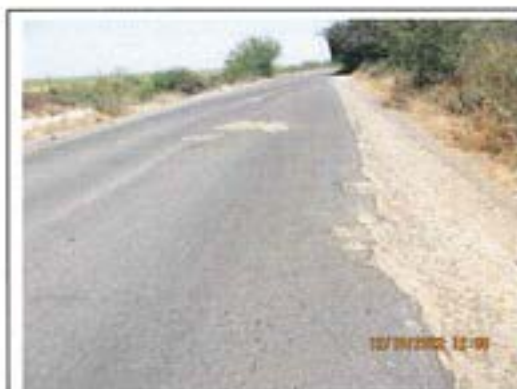
Desprendimiento de Slurry Seal en ambos carriles en la progresiva 4+720.
