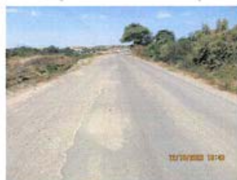
Desprendimiento de Slurry Seal en ambos carriles en la progresiva 30+160.
