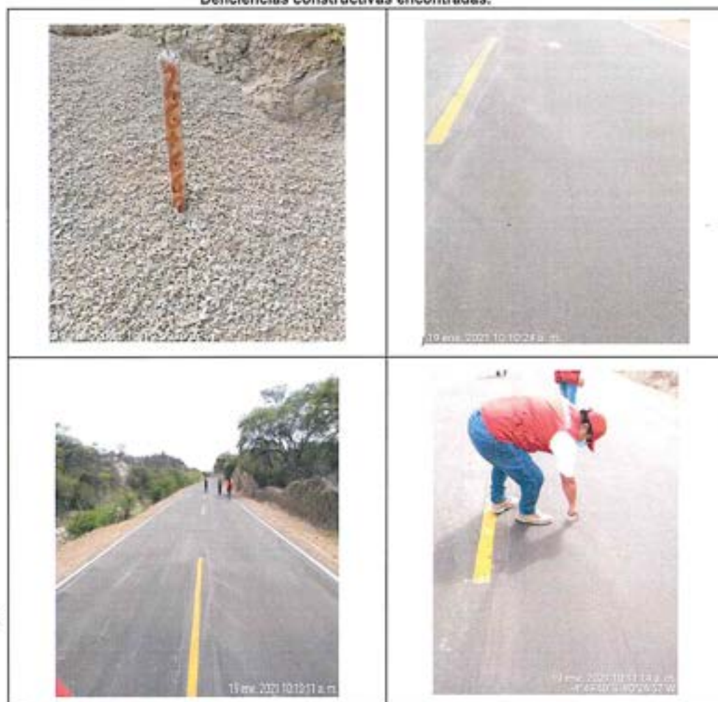
Vistas Fotográficas n.° 4 Deficiencias constructivas encontradas.
