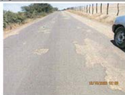
Desprendimiento de Slurry Seal en ambos carriles en la progresiva 9+360.
