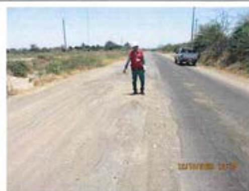
Desprendimiento de Slurry Seal en ambos carriles en la progresiva 5+250.
