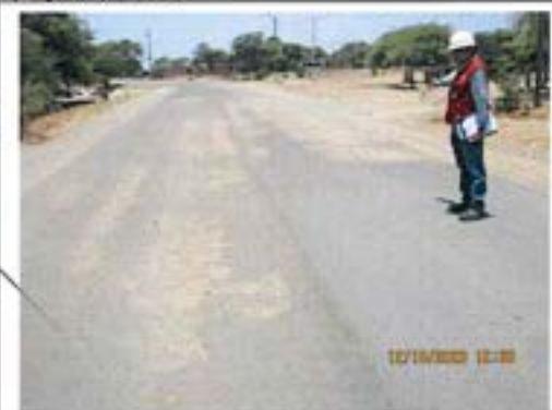
Desprendimiento de Slurry Seal en ambos carriles en la progresiva 10+020.
