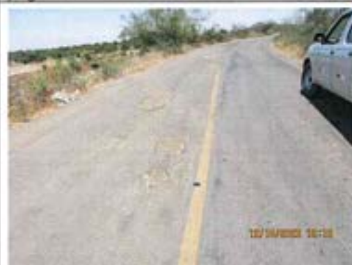
Desprendimiento de Slurry Seal en carril izquierdo de la progresiva 6+530.
