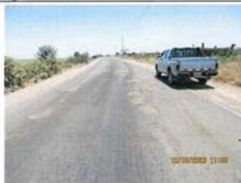
Desprendimiento de Slurry Seal en ambos carriles en la progresiva 2+190.
