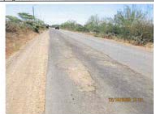
Desprendimiento de Slurry Seal en carril izquierdo en la progresiva 8+250.
