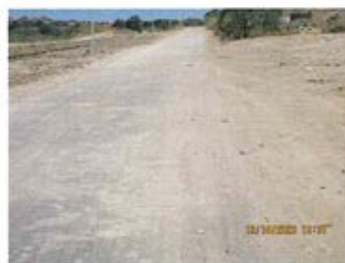
Desprendimiento total de Slurry Seal en ambos carriles en la progresiva 29+090.
