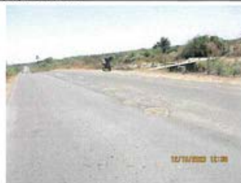
Desprendimiento de Slurry Seal en carril derecho en la progresiva 12+520.
