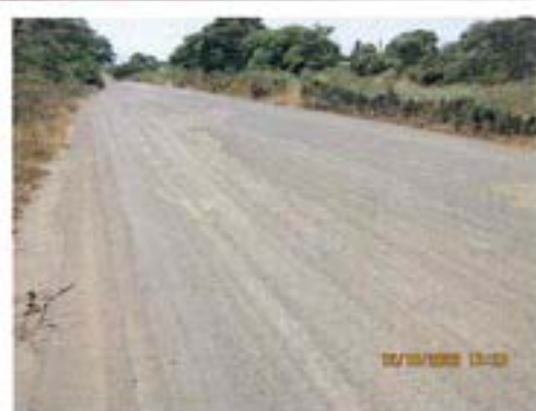
Desprendimiento de Slurry Seal en ambos carriles en la progresiva 26+150.
