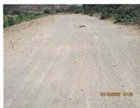
Desprendimiento de Slurry Seal en ambos carriles en la progresiva 27+130.
