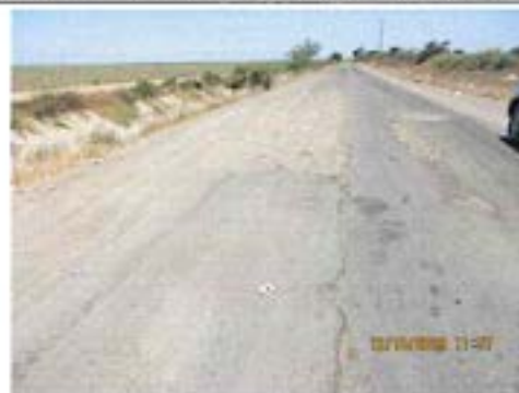
Desprendimiento de Slurry Seal en ambos carriles en la progresiva 2+580.
