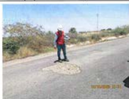
Desprendimiento de Slurry Seal en carril izquierdo de la progresiva 0+120.
