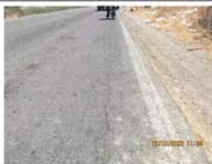
Fisuras en el carril derecho de la progresiva 0+160.
