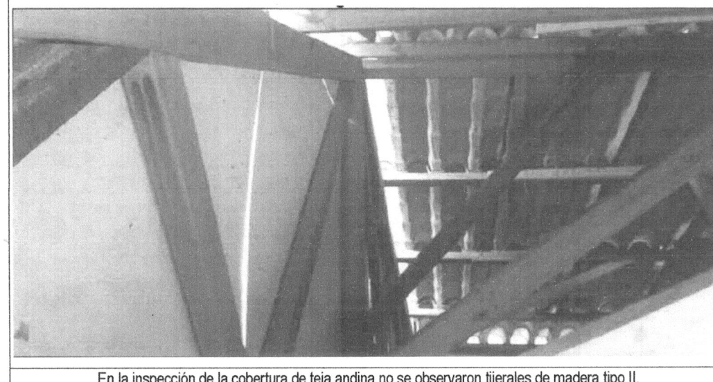
En la inspección de la cobertura de teja andina no se observaron tijerales de madera tipo II.
