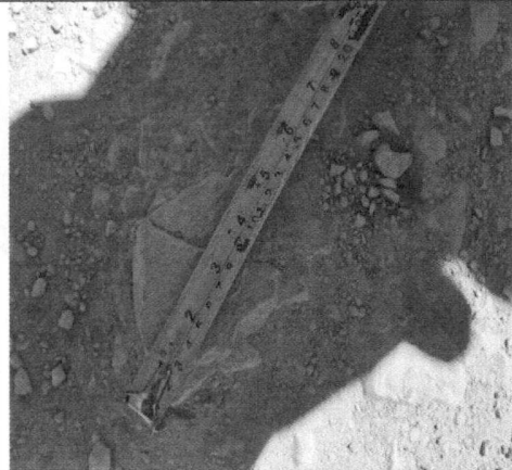
En la imagen n.º 9, se observa en la progresiva 3+300 con grava de 5 pulgadas aproximadamente.
