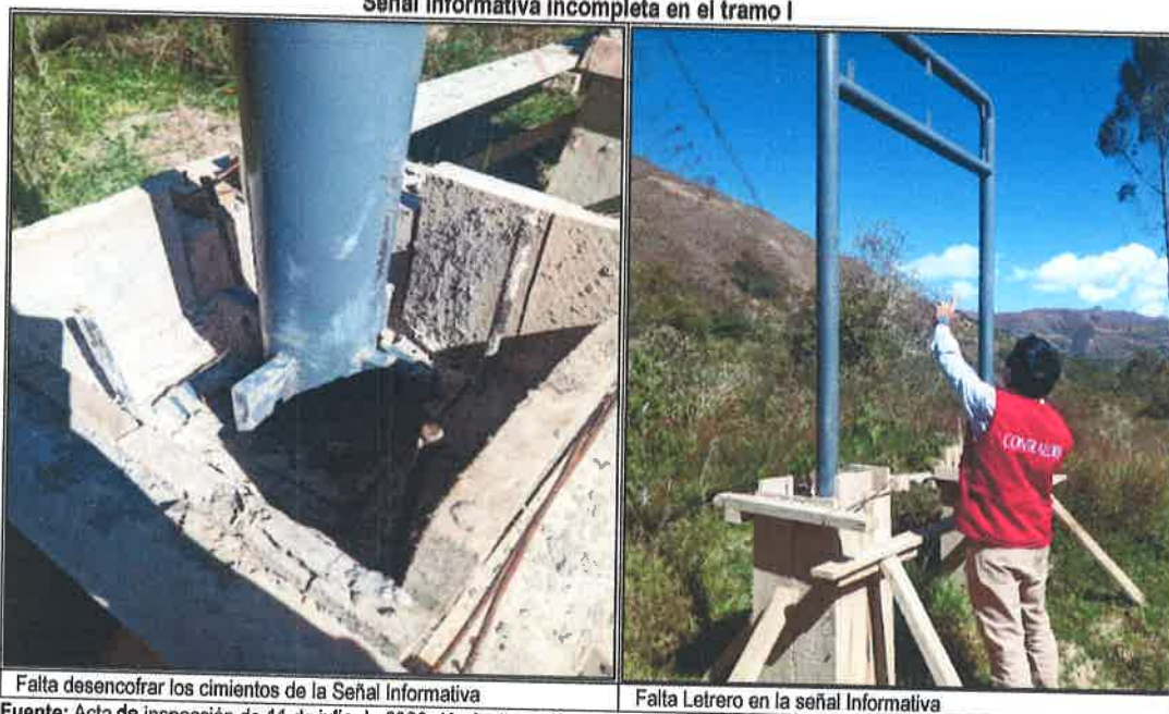
Imágenes n.ºs 14 y 15 Señal Informativa Incompleta en el tramo I
