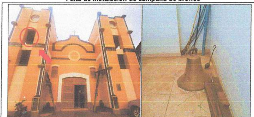
Fotografía n.º 3 Falta de instalación de campana de bronce
