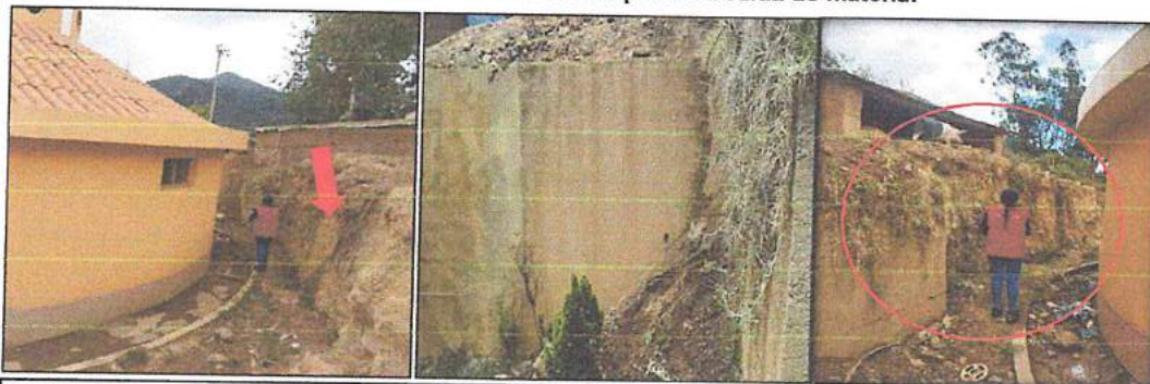
Fotografía n.º 2 Ausencia del muro de contención provoca caída de material
