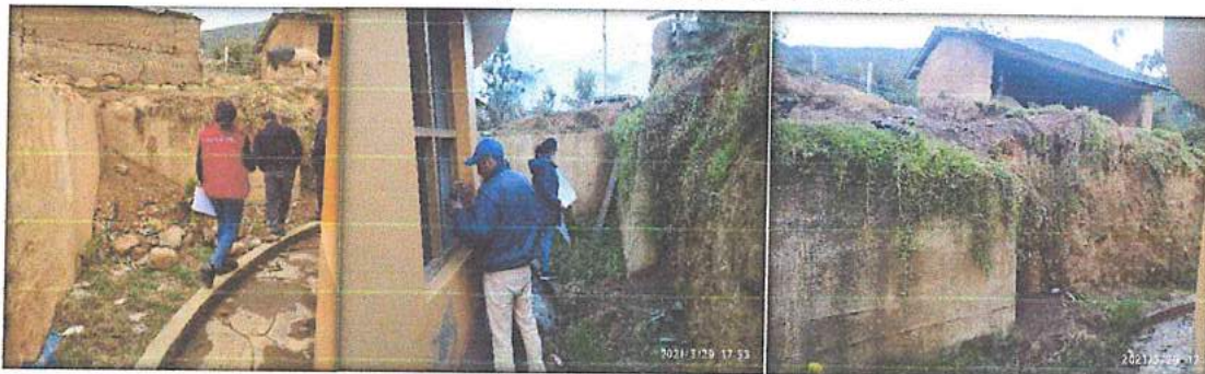
Fotografía n.º 1 Caída de material por encima del muro de contención
