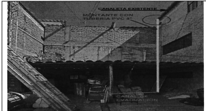
Carencia de sistema de evacuación de aguas pluviales.
