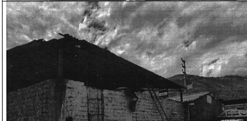
Techo deteriorado, presencia de humedad y deficiente sistema de evacuación de aguas pluviales Fuente: Informe Técnico n.° 001-2023-MPH-OCI/YRSO de 6 de junio de 2023. (Apéndice n.° 9)
