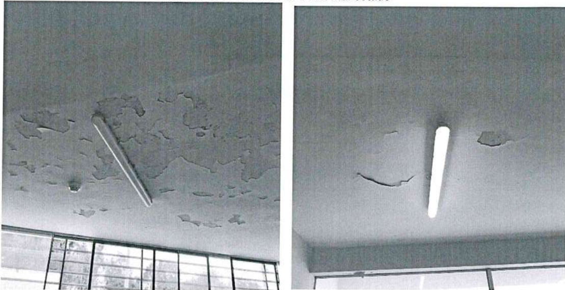
Imágenes n.° 11 Techo de la cocina del CAR en mal estado
