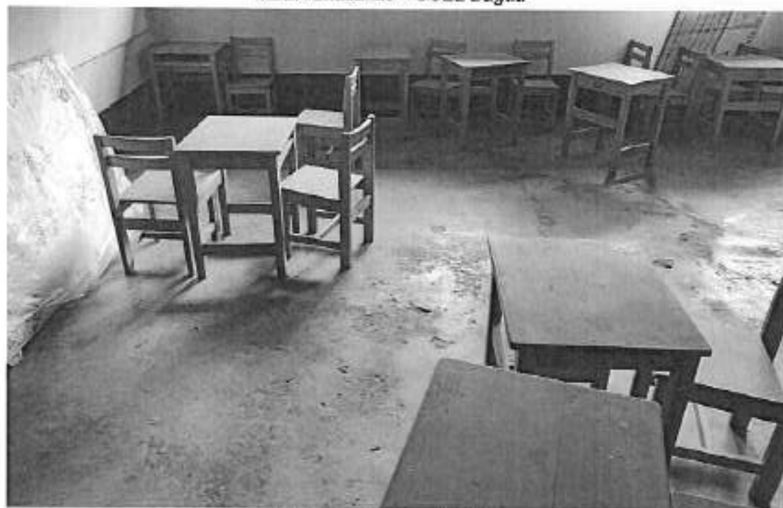
Pisos de aula en mal estado
