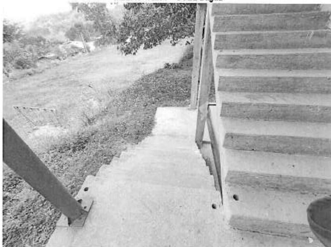
Escaleras de la II.EE. no cuentan con barandas
