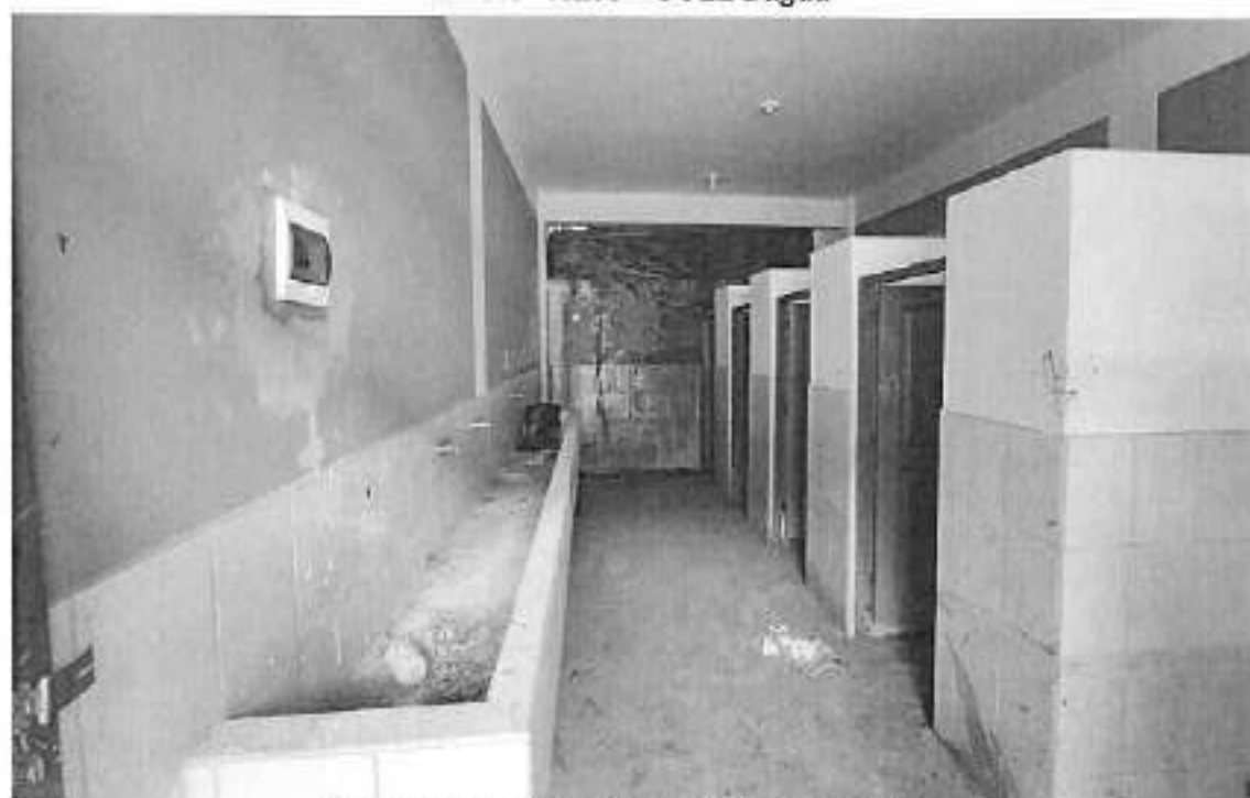
Baños malogrados debido a huaico en la II.EE.
