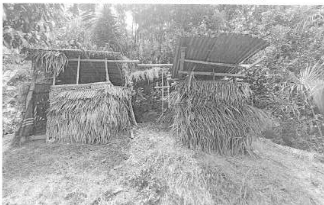
Servicios higiénicos en condiciones inadecuadas
