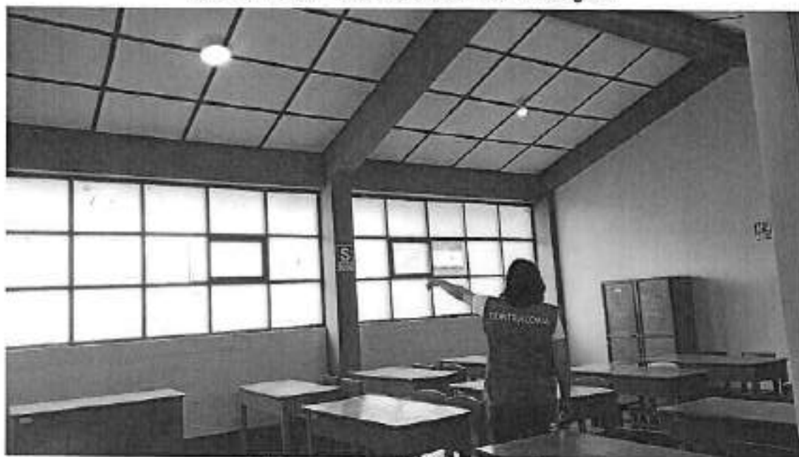
Ambientes con ventilación inadecuada
