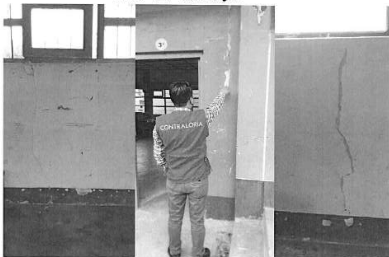
Parades de las aulas de la II.EE. en mal estado
