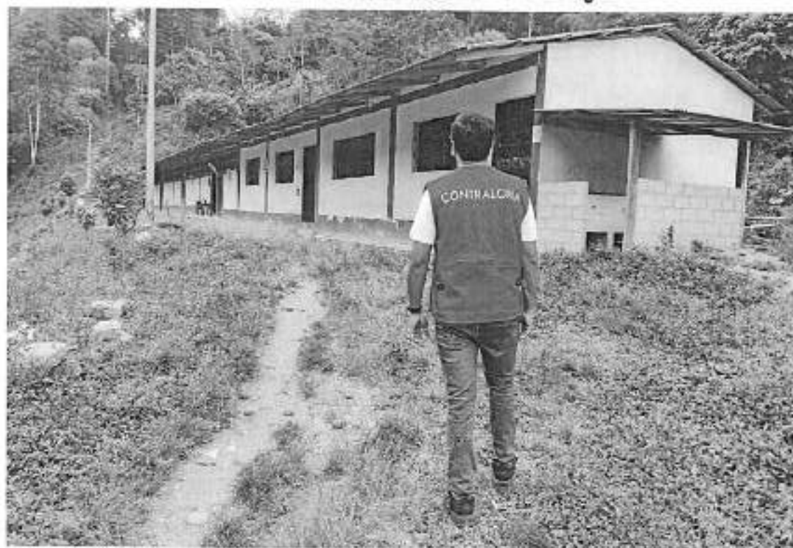
Falta de rampas de acceso en la entrada principal
