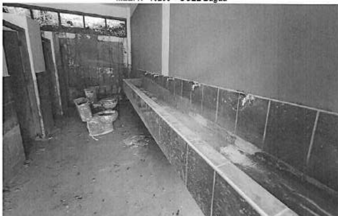
Baños malogrados debido a huayco en la II.EE.
