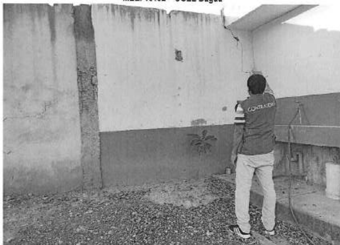
Grietas en cerco perimétrico de la IIEE
