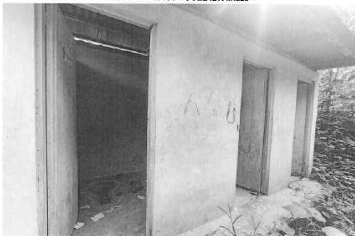
Servicios higiénicos en condiciones inadecuadas
