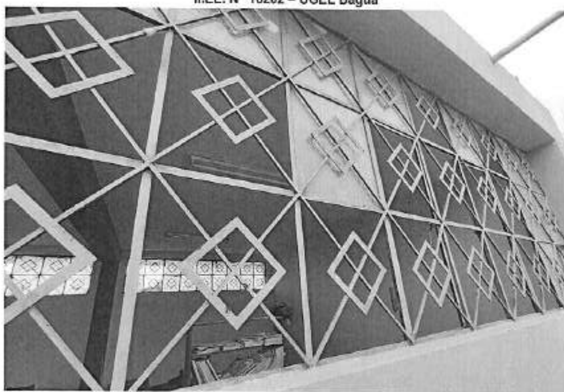
Falta de vidrios en las ventanas de la aulas
