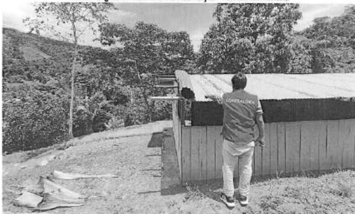
Techo de la II.EE. en mal estado
