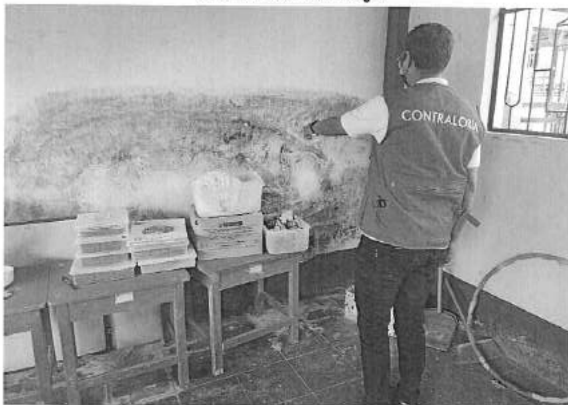
Paredes de aulas en mal estado
