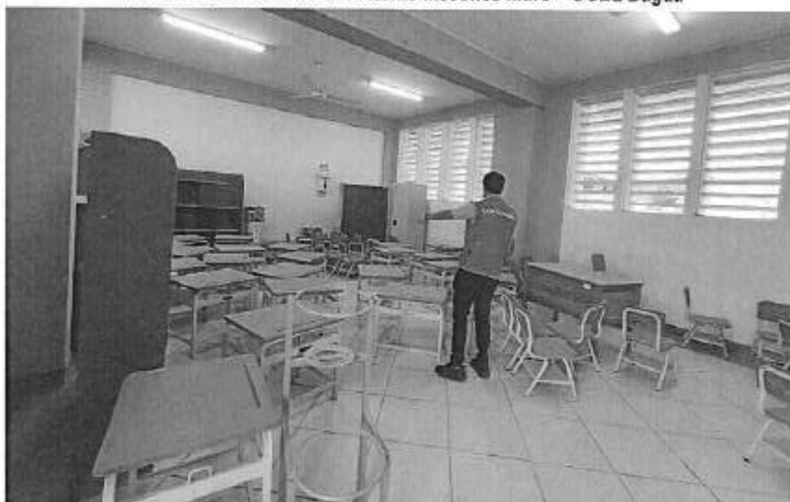
Aula sin aforo, con mobiliario sin distribuir y sin señalización en piso y paredes
