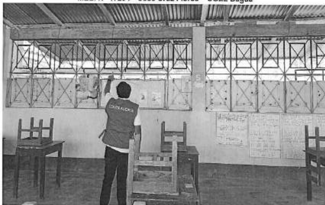
Ventanas de las aulas en mal estado sin protección
