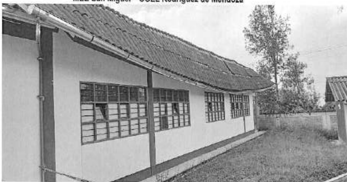
Techo de las aulas de la II.EE. a punto de caer
