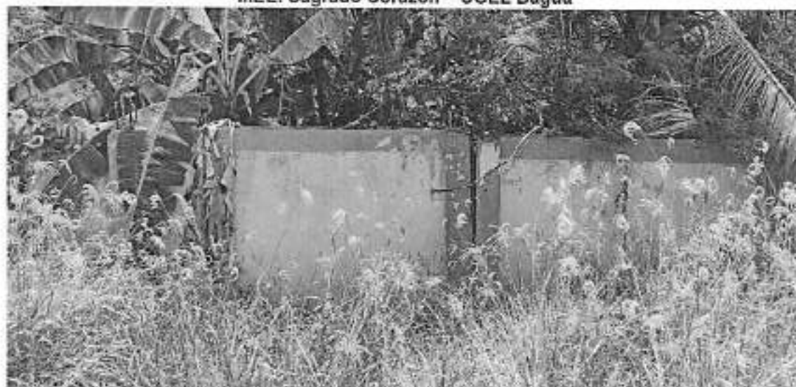
El cerco perimétrico de la IIEE se encuentra en mal estado (parte derrumbada)
