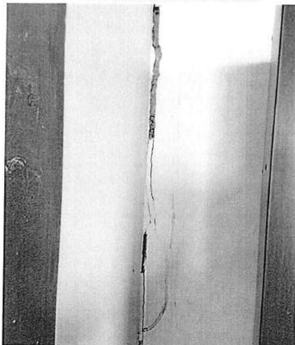
Fisura presentada entre el vértice de las paredes del aula.
