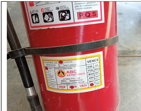
IE José Matías Manzanilla (Ica, Ica, Ica) Extintores vencidos en 2020.
