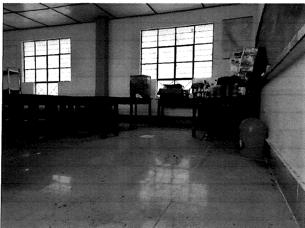
Imagen n.º 3 y 4: Se aprecia los vidrios rotos de la puerta del aula donde se observó mobiliario, kits de limpieza y desinfección.
