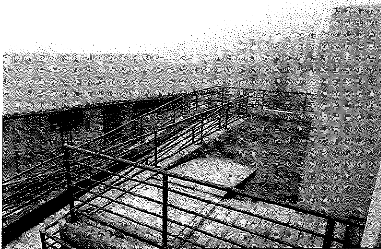
Imágenes n°s 3 y 4: La rampa principal interna de acceso se encuentra obstruida por lodo que impediría la normal circulación.
