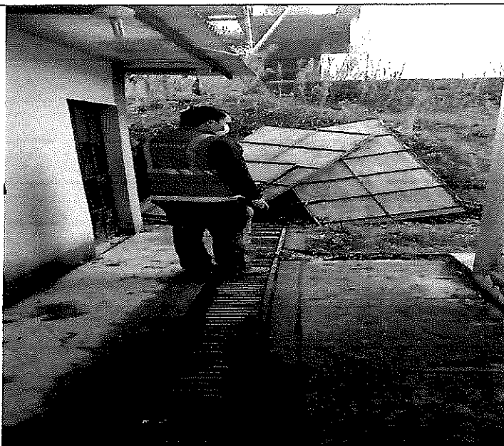
Imagen nº 5: Presencia de puertas de metal oxidadas en pasillos.
