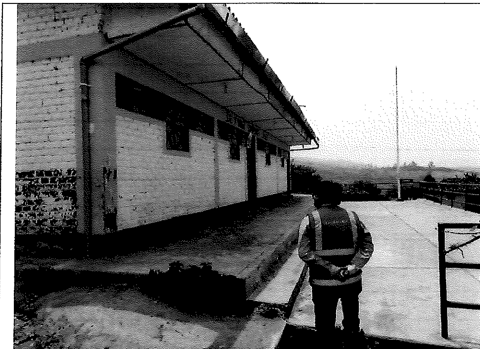
Imagen n.º 2: Se aprecia filtraciones y eflorescencia en los muros del aula de la institución educativa.
