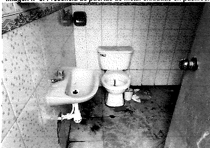
Imagen nº 6: Los servicios higiénicos estaban sucio y en mal estado
