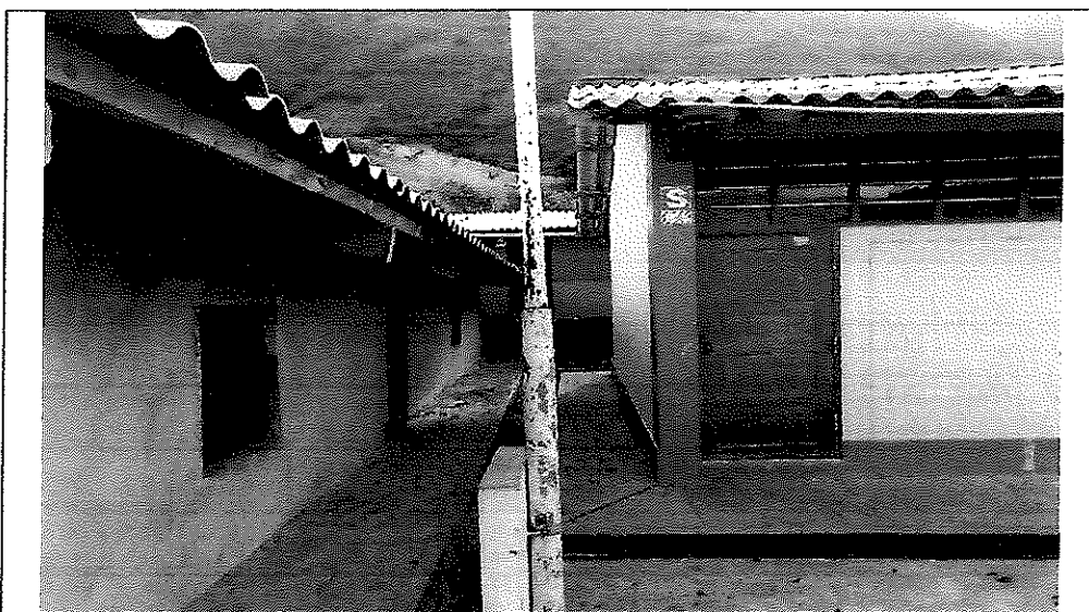
Imagen n.º 8: Se aprecia un vidrio roto en un aula y la necesidad de realizar mantenimiento en paredes.
