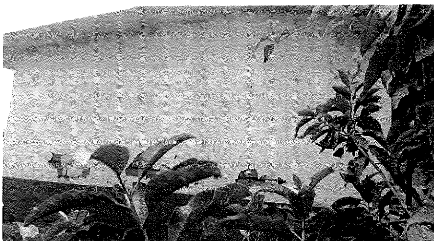
Imagen n.º 4: Se aprecian grietas en las paredes de adobe de las aulas.
