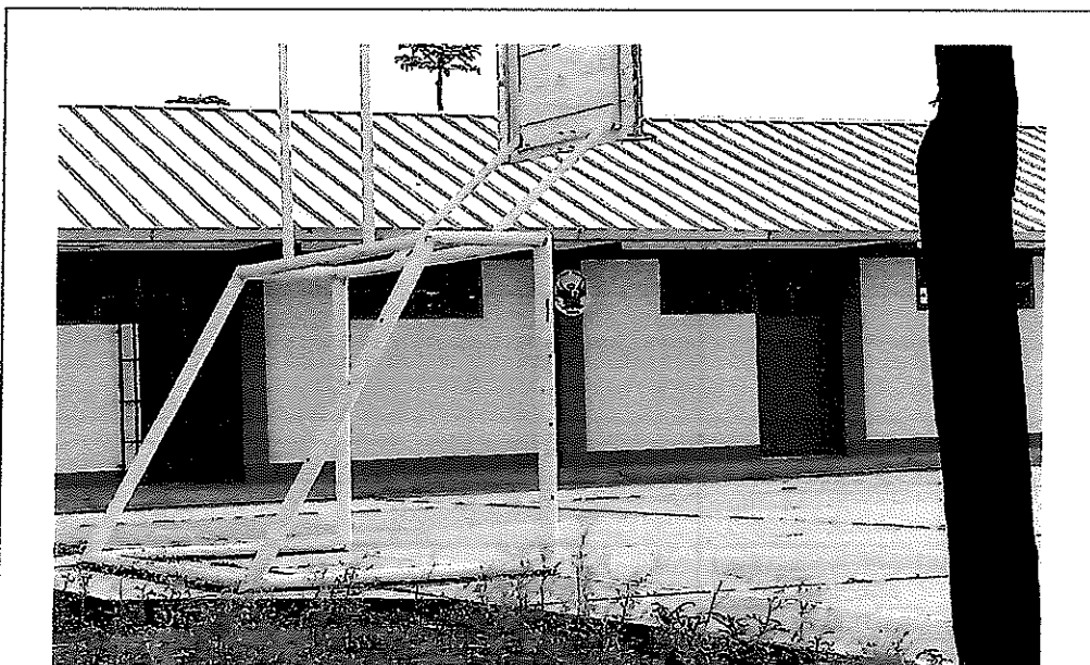
Imagen n.º 2: No se aprecian en muros externos señales informativas de aforo máximo permitido, distanciamiento físico, uso correcto de mascarillas y el lavado o desanexión de manos.
