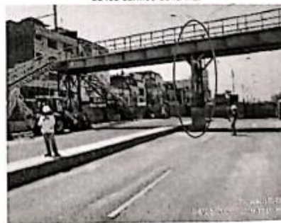
Fotografía 18: Base del puente peatonal existente, ubicada en la calzada, que interfiere con el tránsito vehicular de uno de los carriles de la vía.
