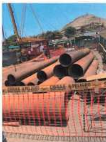
Foto 13: Tuberías en proceso de oxidación que se utilizan para el proceso constructivo. No es la tubería definitiva de la columna de producción.
