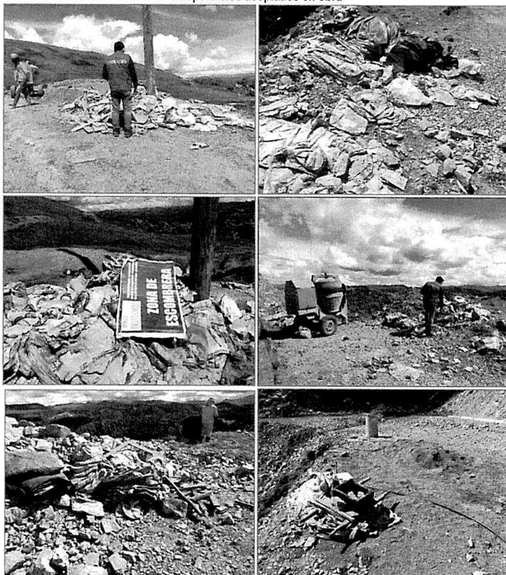
Imagen n.º 4 Desperdicios acopiados en obra
