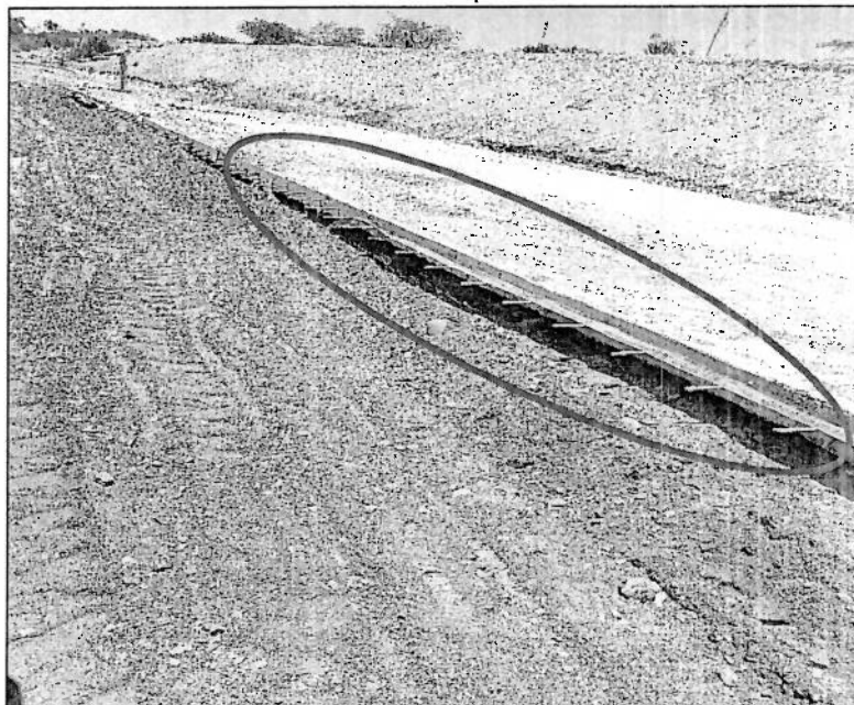
Imagen n.º 2 Socavación por debajo de la losa de concreto entre las progresivas 32+160 hasta la 32+200 aproximadamente
