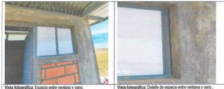
Vista fotográfica: Espacio entre ventana y vano.
