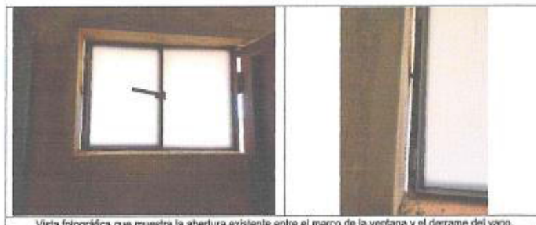
Vista fotográfica que muestra la abertura existente entre el marco de la ventana y el derrame del vano.
