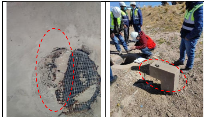
Vistas fotográficas N°s 44 y 45: El sistema de ventilación de las válvulas de aire N° 02 y 03 del sistema de impulsión de agua, se encuentran parcialmente cubiertas con concreto, impidiendo su funcionamiento efectivo -18.05.22.
