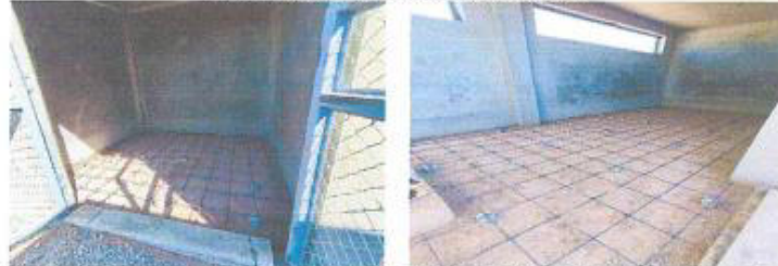
Vista fotográfica: Ambiente de grupo electrógeno con malla de refuerzo de piso.
