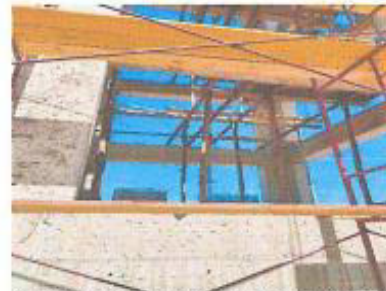
Vista fotográfica: Detalle de rolizos en el primer nivel de la cisterna.
