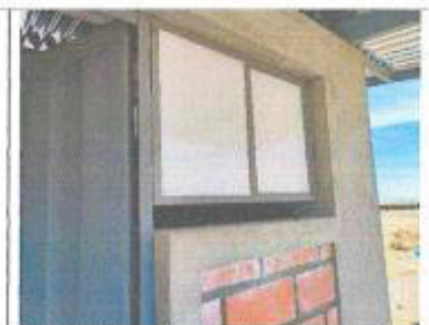
Vista fotográfica: Detalle de ventana metálica menor al vano; nótese el espacio entre ellos.
