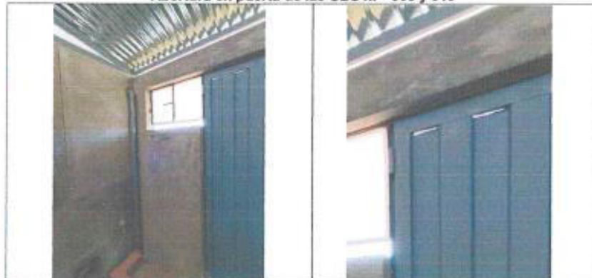
Vista fotográfica que muestra la abertura existente entre la plancha acanalada de la puerta y el ángulo del marco superior.
