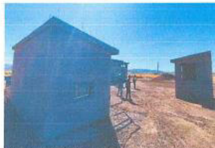
Vista fotográfica: Módulo de caseta de seguridad y ambiente de grupo electrógeno con techos inclinados.
