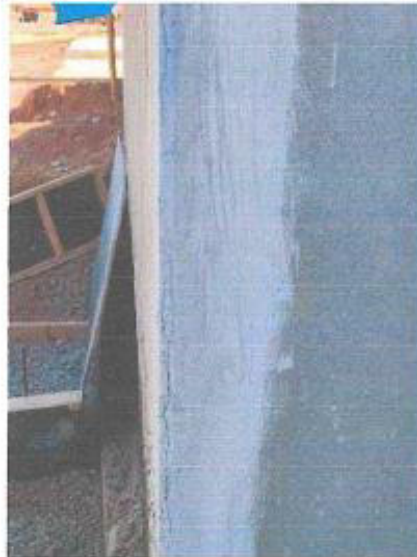
Vista fotográfica: Fisuramiento de revestimiento de la caseta de bombeo.
