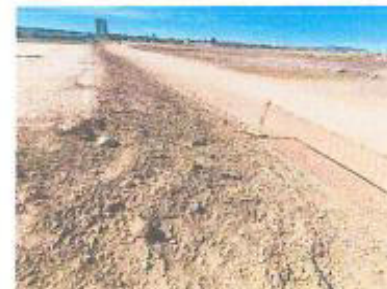
Vista fotográfica: Tramo con malla de seguridad; nótese que un lado no cuenta con mallas de seguridad.
