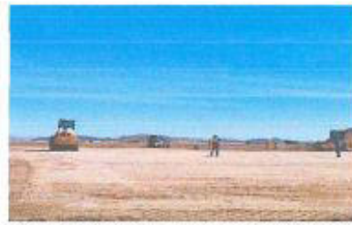
Vista fotográfica: Conformación de capa de transferencia en la PTAR; nótese la falta de vigia para el control de trabajos de maquinaria.
