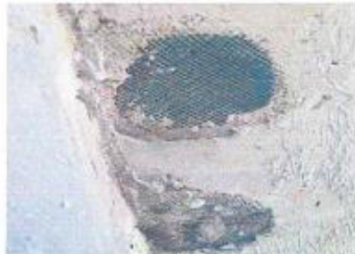
Vista fotográfica: Salida de ventilación con malla tipo mosquetero; nótese que una de ellas se encuentra cubierta por concreto.
