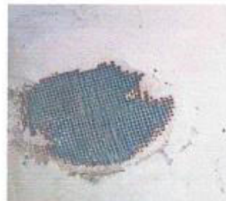
Vista fotográfica: Salida de ventilación con malla tipo mosquetero; nótese que se encuentra cubierta por concreto.
