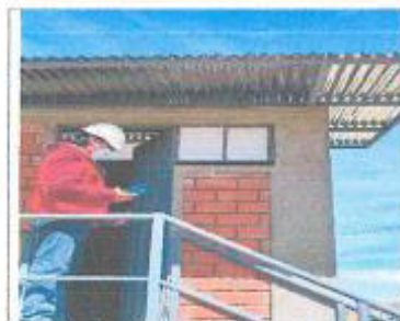
Vista fotográfica: Ventana metálica menor al vano.
