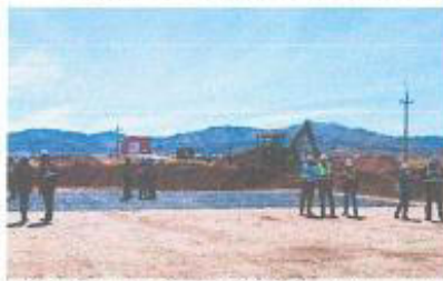
Vista fotográfica: Plataforma de la PTAR; nótese que no se cuenta con cerco perimétrico.
