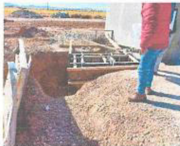
Vista fotográfica: Encofrado de cámara de rebose sin cinta de señalización y malla de seguridad.
