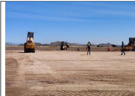
Vista fotográfica N° 7.- Conformación de la plataforma de transferencia en la PTAR - 17.05.22.
