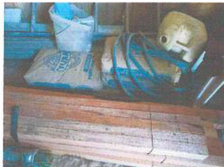
Vista fotográfica: Listones de madera que no corresponderían al tipo tornillo. Nótese tres bolsas de cemento apoyados en el terreno natural.
