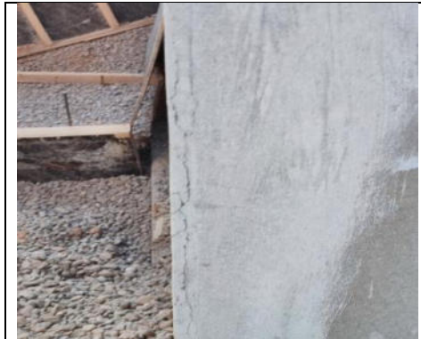
Vista fotográfica N° 29: Presencia de fisuras en revestimiento de columna esquinera de caseta de estación de bombeo -19.05.22.
