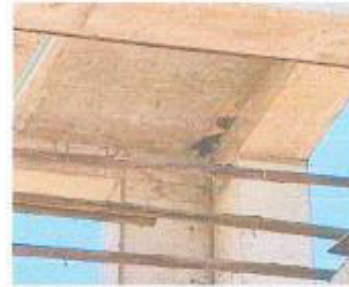
Vista fotográfica: Detalle de cangrejera en base de la cisterna elevada.
