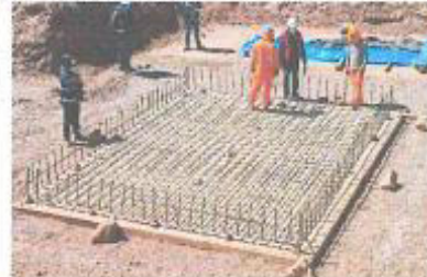
Vista fotográfica: Barras verticales de la malla de acero sin capuchones – lado izquierdo; nótese presencia de dos operarios en este frente.
