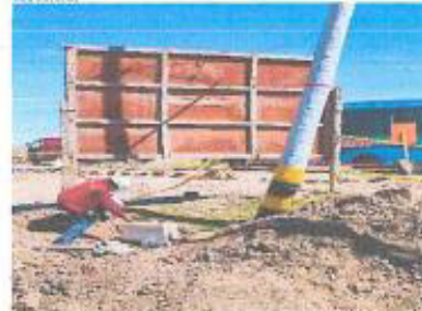
Vista fotográfica: poste de concreto quebrado ubicado al costado de la estructura CP 1.
