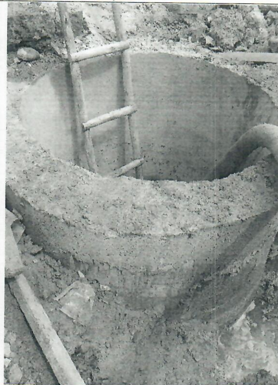
Vista de buzón n.º 6 con presencia de madera triplay adherida a su cuerpo de concreto, en la sección, con vista en dirección al sureste.
