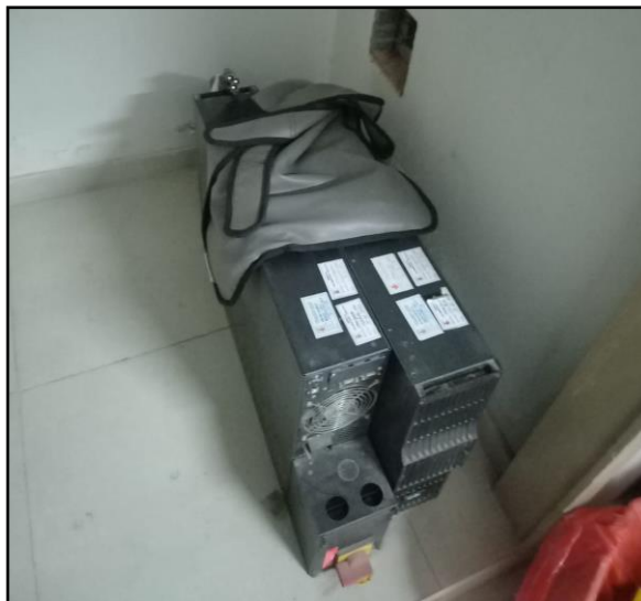
Figura n.º 5: UPS
