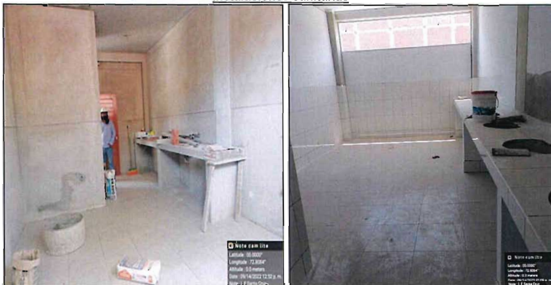
Imágenes n.º 59 y 60 Instalaciones sanitarias
