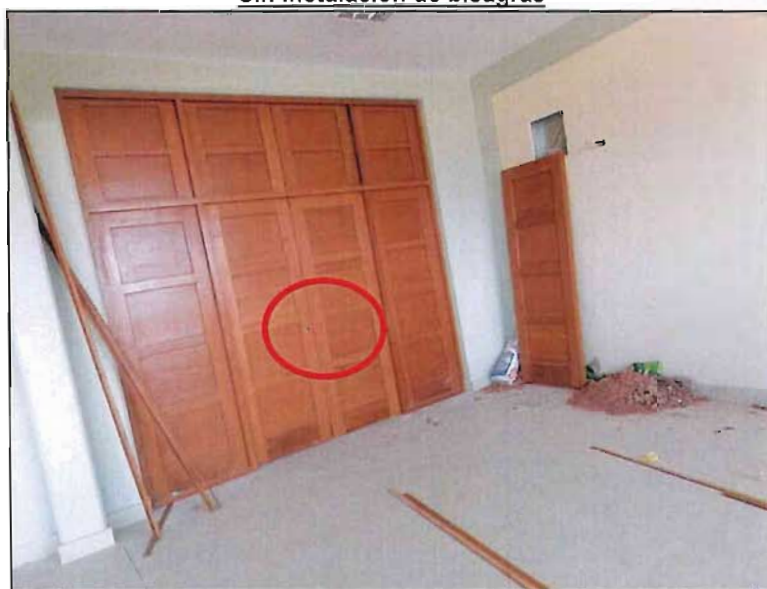
Imagen n.º82 Sin instalación de bisagras
