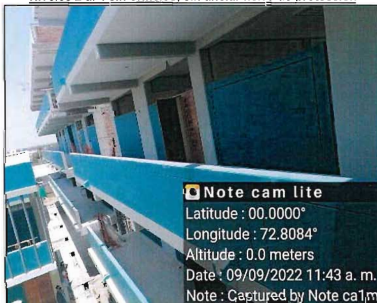
Imagen n.º 19 Niveles 2 al 4 sin orificios, sin anclar fierro de protección
