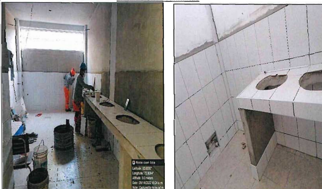
Imágenes n.º 61, 62 Instalaciones sanitarias
