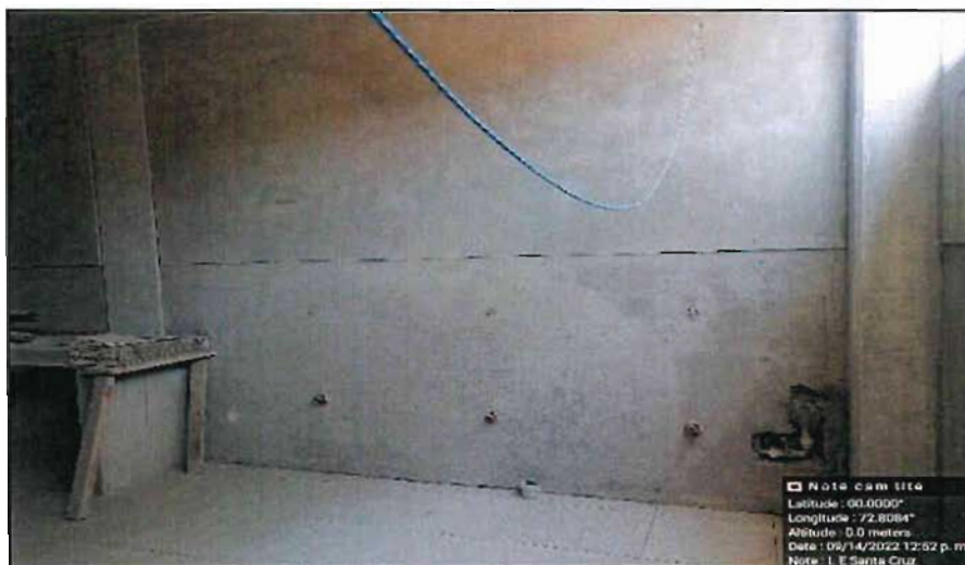
Imagen n.º 63 Instalaciones sanitarias
