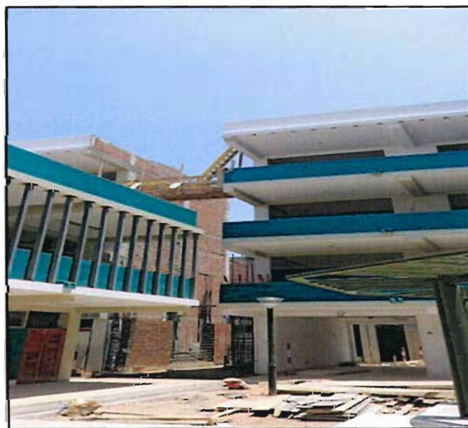
Imagen n.º87 Niveles 2 al 4 sin anclar fierro de protección
