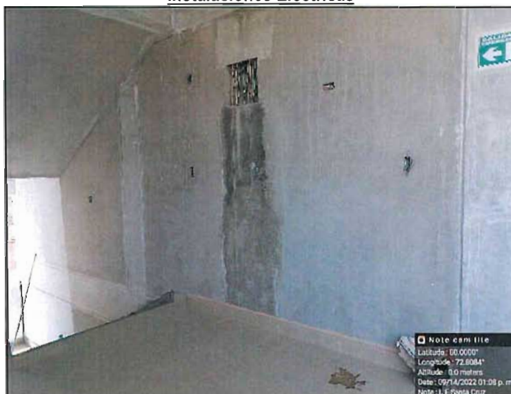
Imagen n.º 64 Instalaciones Electricas
