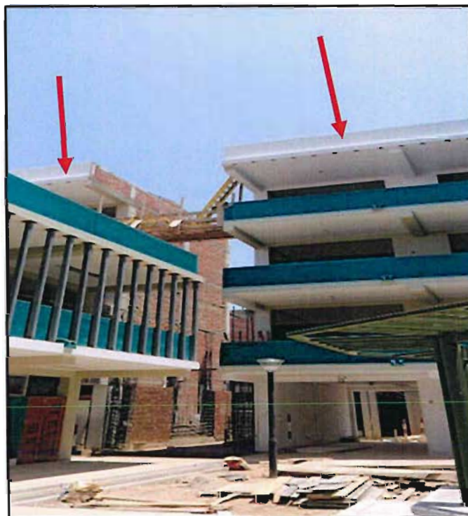
Imagen n.º48 Niveles 2 al 4 Pabellones sin anclado de fierro de protección
