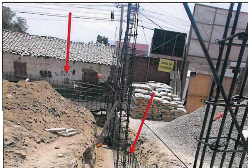
Imagen n.º 45 Perimetro calle lima sin ejecutar muro.
