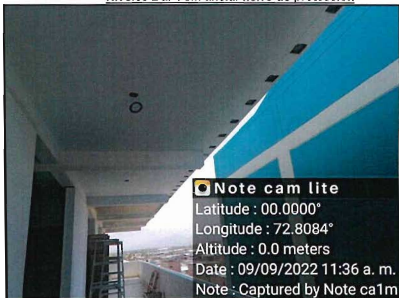
Imagen n.º86 Niveles 2 al 4 sin anclar fierro de protección
