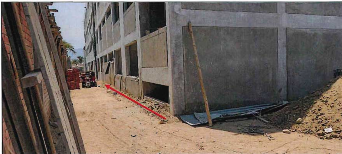
Imagen n.º 27 Exterior del Pabellón n.º 2 Sin ejecutar vereda.
