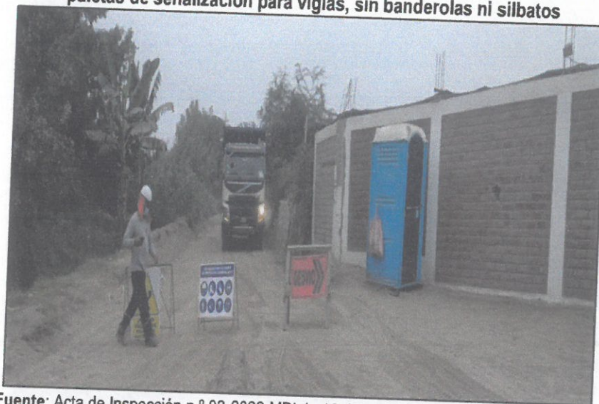
Imagen n.º 10 Progresiva 0+100 aproximadamente, si visualiza personal de obra sin paletas de señalización para vigías, sin banderolas ni silbatos
