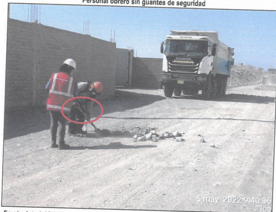
Imágenes n° 17 Personal obrero sin guantes de seguridad
