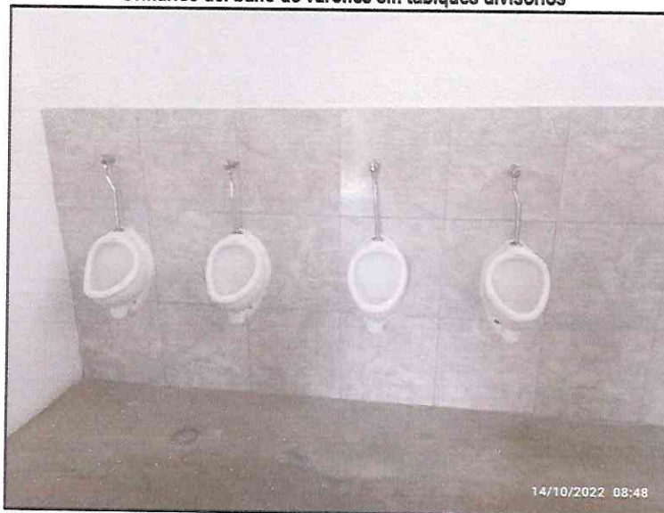
Imagen n.° 11 Urinarios del baño de varones sin tabiques divisorios
