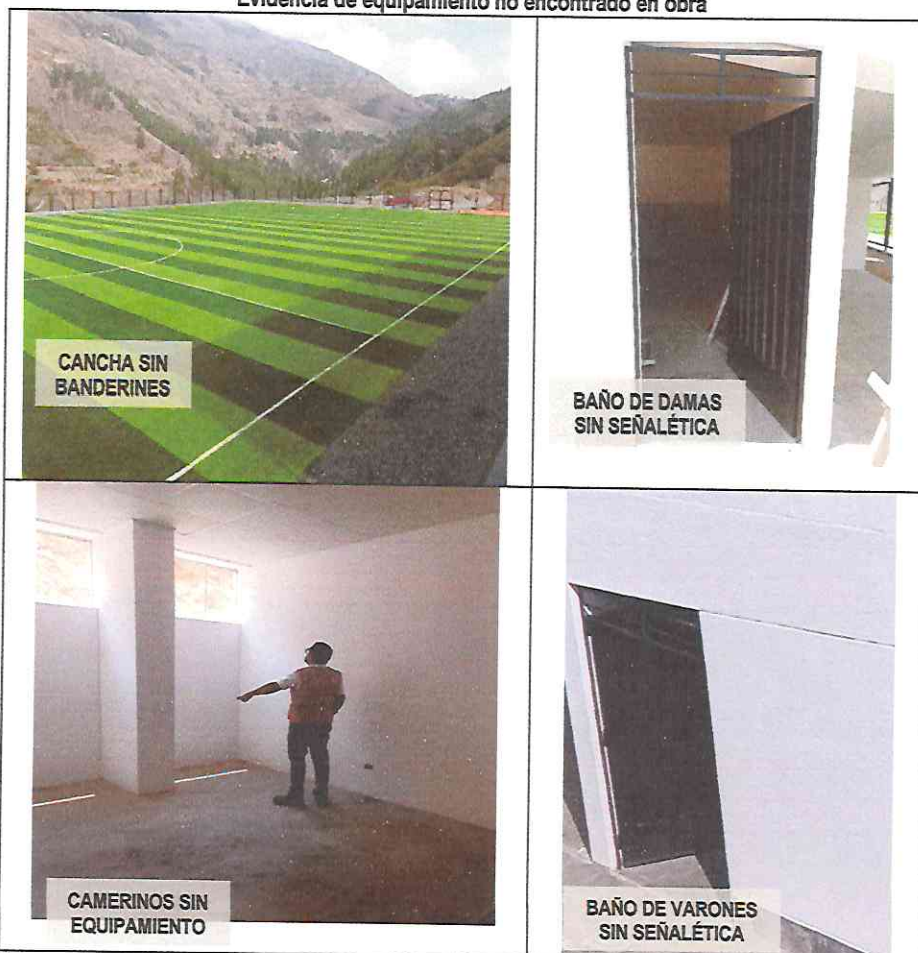
Imagen n.º 20 Evidencia de equipamiento no encontrado en obra
