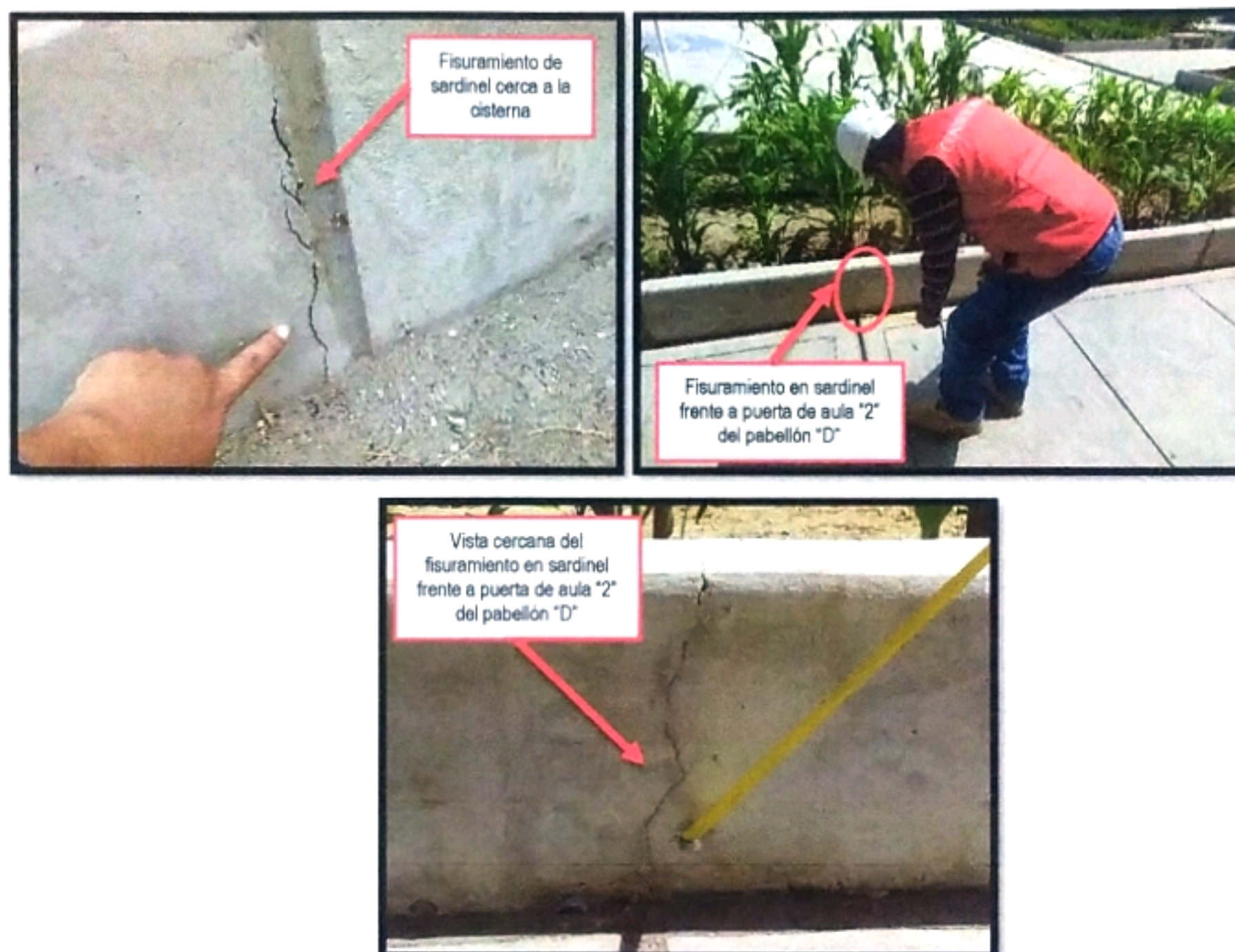
IMAGEN N° 16 FISURAS EN SARDINELES
