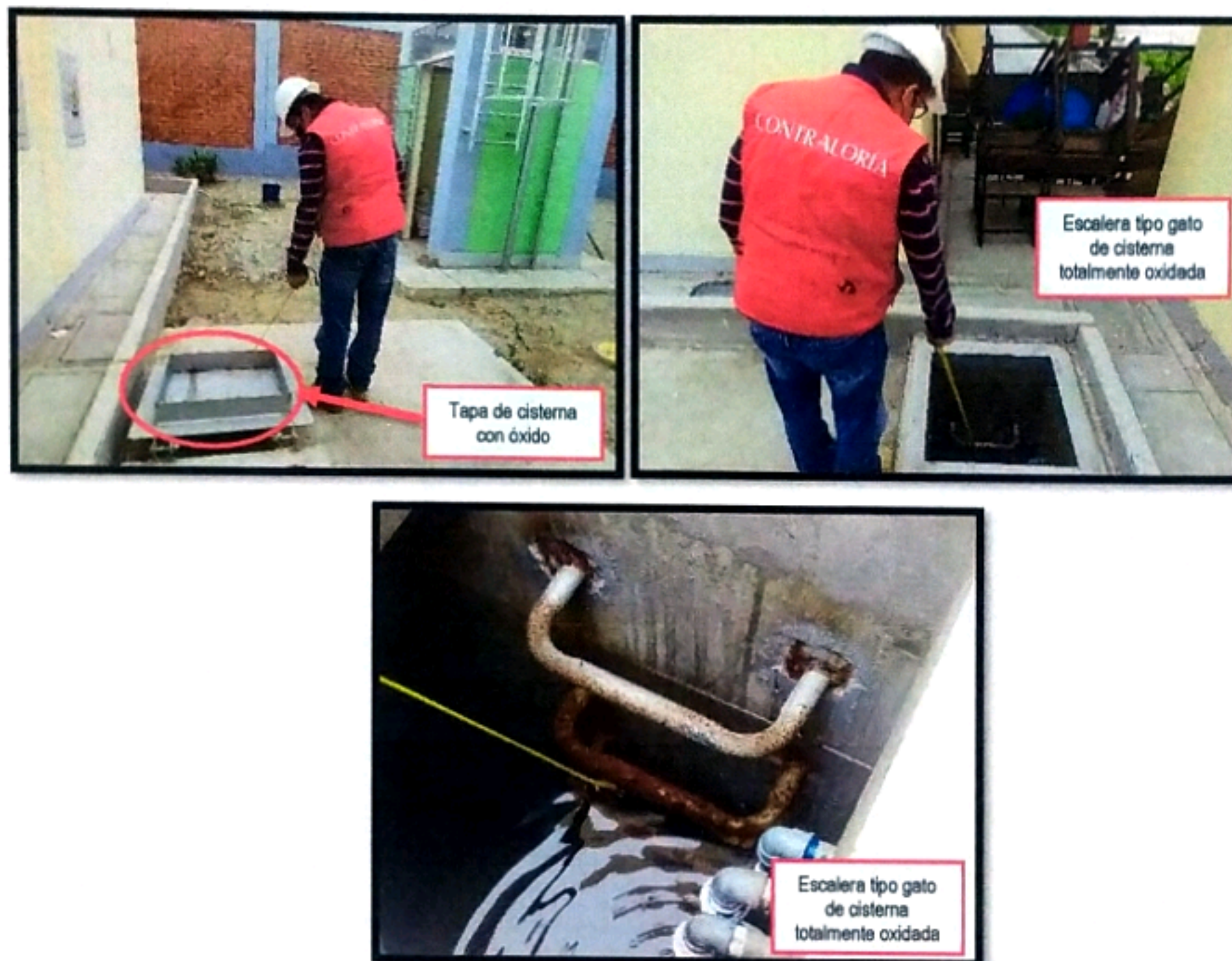
IMAGEN N° 5 ESTRUCTURA METÁLICA DE LA CISTERNA CON ÓXIDO
