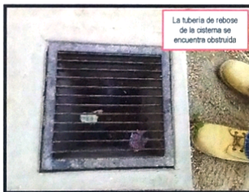
IMAGEN N° 7 TUBERÍA DE REBOSE DE CISTERNA OBSTRUÍDA
