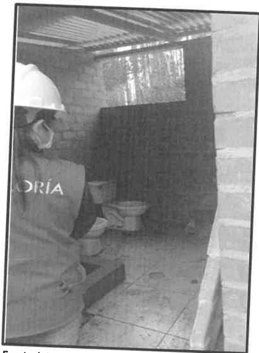
Imagen n.º 6 Baños Higiénicos instalados en obra no son utilizados
