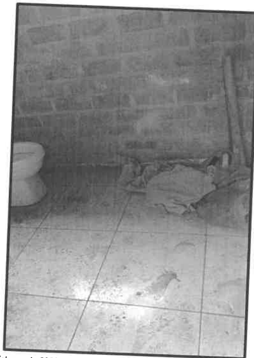
Imagen n.º 7 Baños higiénicos de la obra no cuentan con adecuadas condiciones de salubridad
