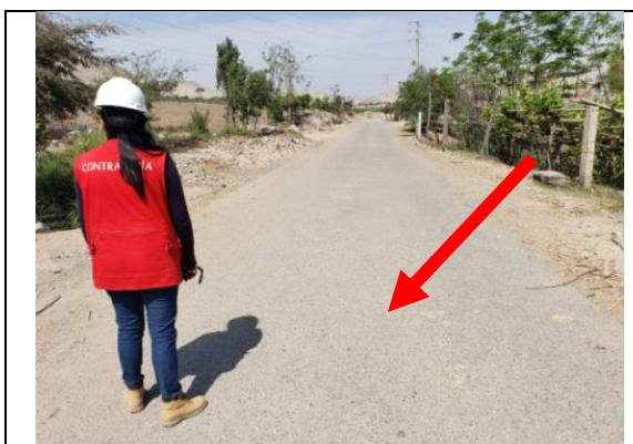
Imagen n.º11.- Se verificó que desde la progresiva 0+320 a la 0+945 aproximadamente presenta menor deterioro en la superficie de la monocapa y base a comparación de la primera parte.
