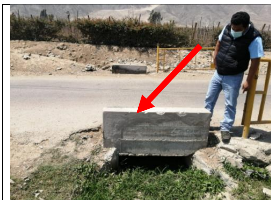
Imagen n.º19.- Se verificó la existencia de alcantarillas de concreto armando en el primero tramo, las cuales se encuentran en estado regular de conservación, sin embargo, les hace falta mantenimiento en la limpieza y desbroce.
