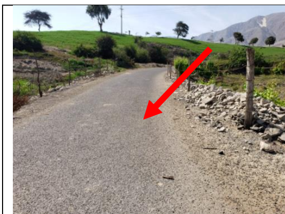
Imagen n.º17.- Se verificó que desde la progresiva 1+205 a la 1+620 aproximadamente presenta menor deterioro en la superficie de la monocapa y base a comparación de la primera parte.
