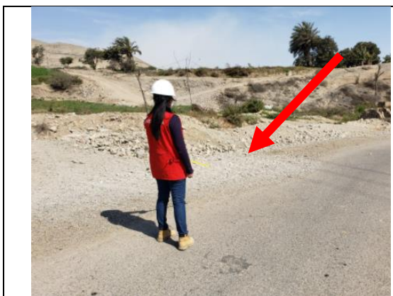
Imagen n.º15.- Se verificó que en todo el trayecto de la vía existe gravilla que se utilizó en la ejecución, en cual se encuentra suelta a los bordes de la vía, como especie de desmonte, por lo que hace falta de limpieza.
