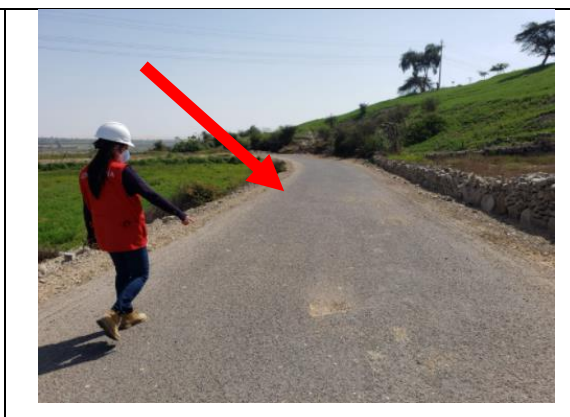
Imagen n.º16.- Se verificó que desde la progresiva 1+205 a la 1+620 aproximadamente presenta menor deterioro en la superficie de la monocapa y base a comparación de la primera parte.
