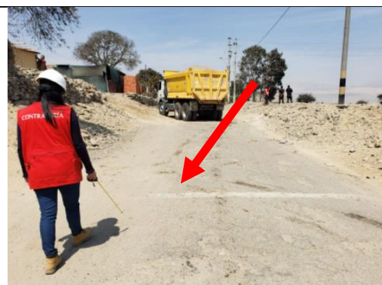
Imagen n.º10.- Se verificó que la vía desde la 0+320 presenta deterioro en la superfi de rodadura con la presencia de pequeños desprendimiento de la monocapa y hundimiento de la base de tamaños variables, además se observó que las personas hacen uso de la vía mediante vehículos de carga.
