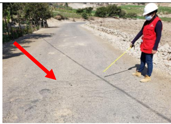
Imagen n.º14.- Se observó que en la progresiva 1+150 la vía presenta ondulaciones a nivel de monocapa, además que presentan desprendimiento de superficie de rodadura y base.
