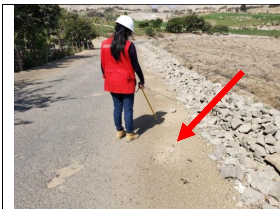
Imagen n.º13.- Se observó que las bermas del lado derecho de la progresiva 1+130 presentan desprendimientos en la monocapa y base, de las cuales se puede observar que la base tiene 0.15 de altura en promedio y presenta piedras de tamaños mayores de 3" de ancho.
