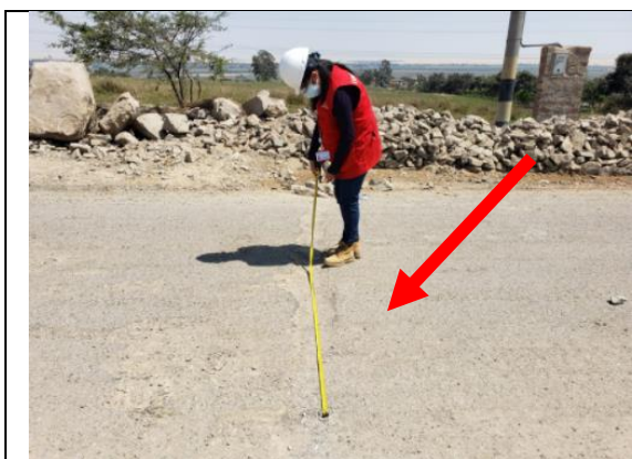
Imagen n.º9.- Se verificó en la progresiva 0+275 se observó que la vía presenta excavación y retiro de la monocapa para la instalación de tubería de agua potable, de superficie de 3.00x0.20 m
