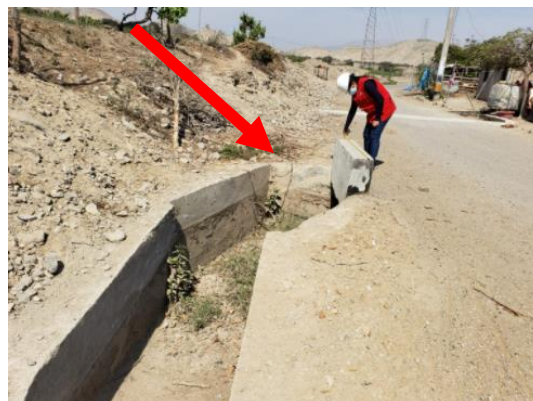
Imagen n.º20.- Se verificó la existencia de alcantarillas de concreto armando en el primero tramo, las cuales se encuentran en estado regular de conservación, sin embargo, les hace falta mantenimiento en la limpieza y desbroce.
