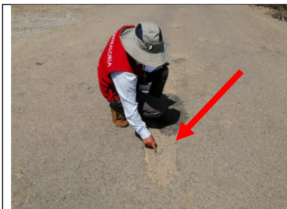
Imagen n.º7.- Se verificó que la que la base de la vía presenta piedras que van desde las 2" a las 4 " de ancho.
