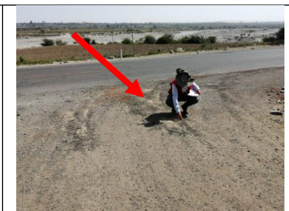
Imagen n.º18.- Se observó que el fin del primer tramo en la progresiva 1+642 presentan desprendimientos en la monocapa y base.
