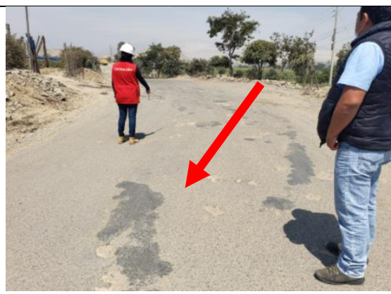
Imagen n.º8.- Se verificó que la vía desde la progresiva 0+120 hacia adelante presenta parches en la superficie de rodadura de diferentes tamaños.
