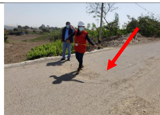
Imagen n.º12.- Se observó que en la progresiva 1+045 aproximadamente, se presenta deterioros de la superficie de rodadura las cuales presentaban pérdida de la capa de rodadura y pérdida de la base, de superficie de 1.50x0.50 m y 0.60x0.50 con hundimientos de base de 2" de altura.
