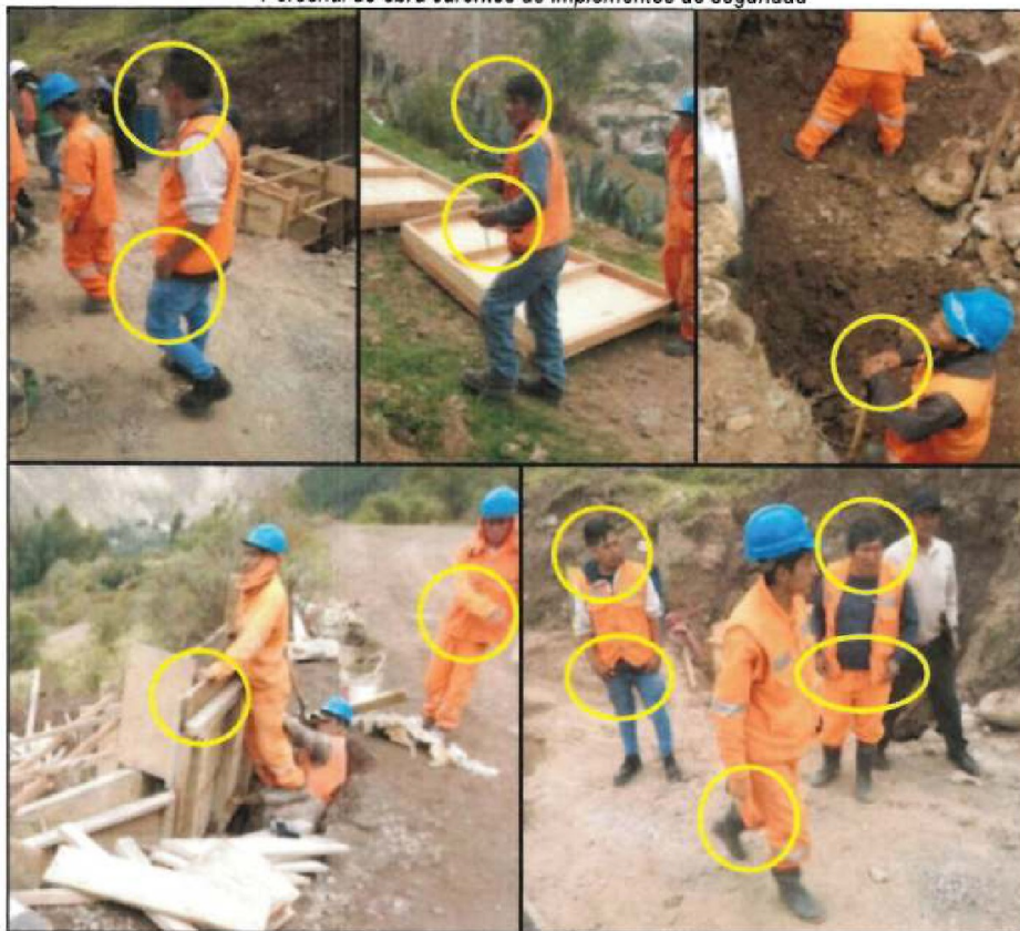
Fotografías n.ºs 17, 18, 19, 20, 21 Personal de obra carentes de implementos de seguridad
