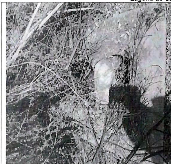
Imagen n.º 2. Se aprecia maleza en el canal de ingreso de la PTAR 1, restringiendo el ingreso de las aguas residuales.
