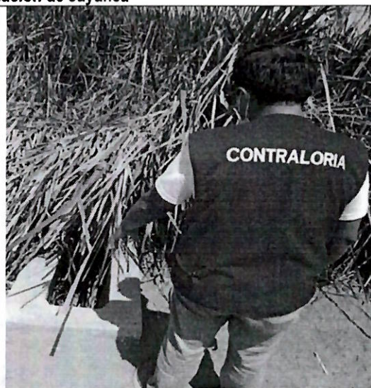
Imagen n.º 3. Se observa maleza en el canal de ingreso de la PTAR 2, restringiendo el ingreso de las aguas residuales.
