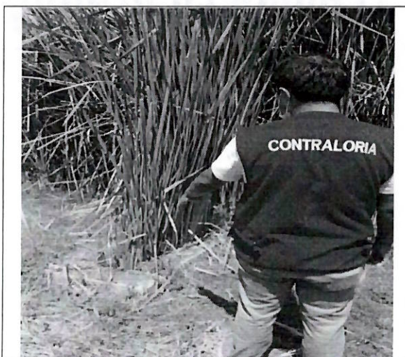
Imagen n.º 4. Se advierte maleza en el canal de ingreso de la PTAR 3, restringiendo el ingreso de las aguas residuales.
