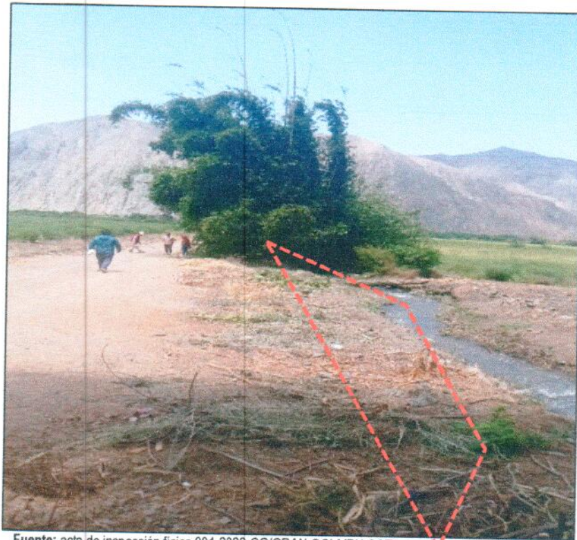
FOTOGRAFIA N° 8 TRAMO EMP.AN-109-TAYCA ZONA AGRÍCOLA NO EXISTE CUNETETA
