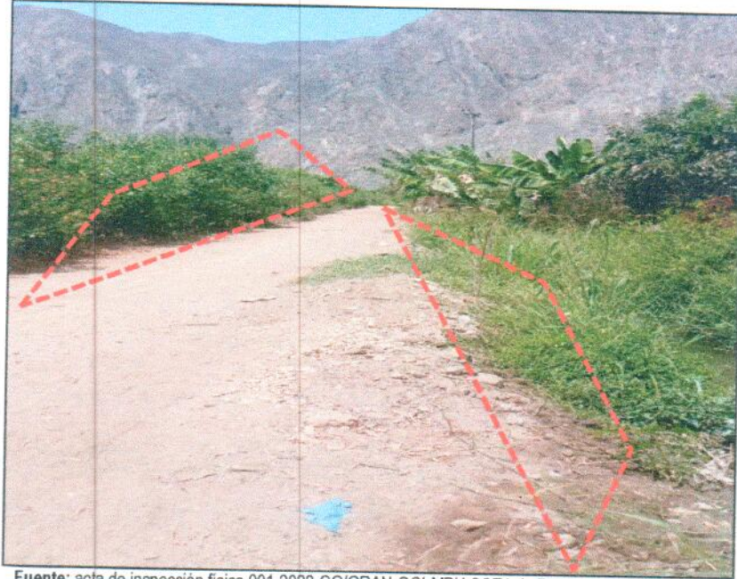
FOTOGRAFIA N° 7 TRAMO EMP.AN-109-TAYCA ZONA AGRÍCOLA NO EXISTE CUNETETA
