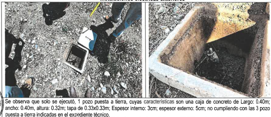
Imágenes n. ros 72 y 73 Instalaciones eléctricas exteriores
