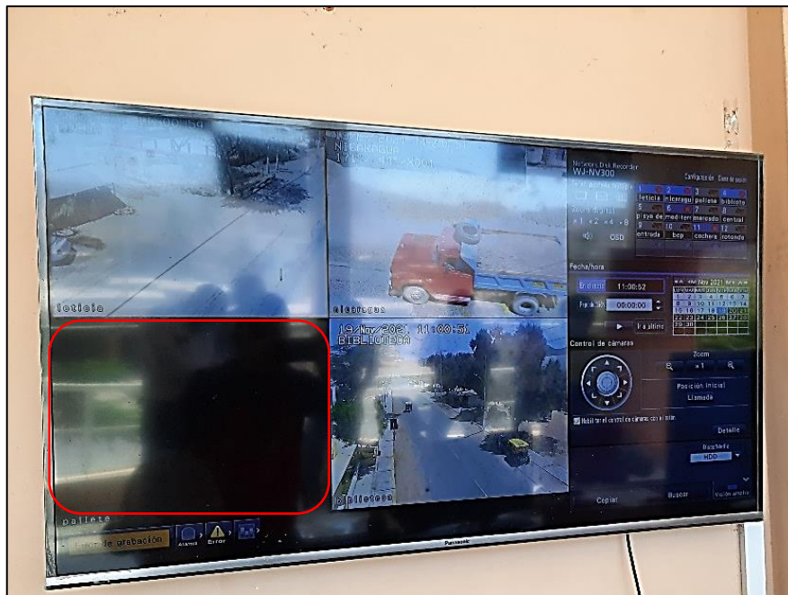
Imagen n.º 5 Monitor que presenta la imagen de la cámara de videovigilancia sin señal.
