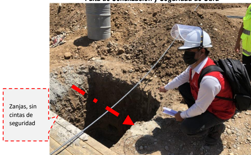
Imagen n.º 9 y 10 Falta de Señalización y Seguridad de Obra
