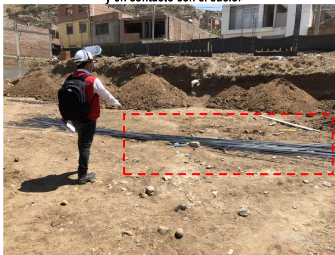
Imagen n.º 5 Acero de refuerzo de ½", expuestos a la intemperie y en contacto con el suelo.
