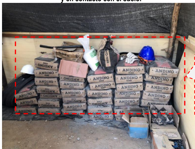
Imagen n.º 6 Cemento, sin cubierta de protección y en contacto con el suelo.
