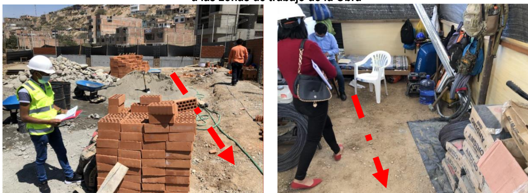
Imagen n.º 7 y 8 Deficiencia en el Acceso y Circulación a las zonas de trabajo de la Obra
