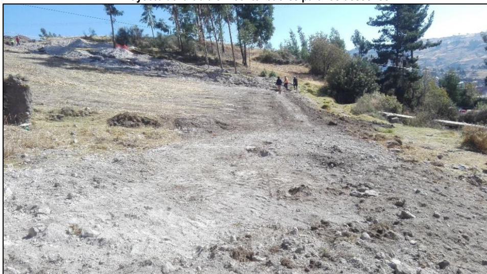
Imagen n.° 9 Trayecto de la obra sin contenedores para los desechos
