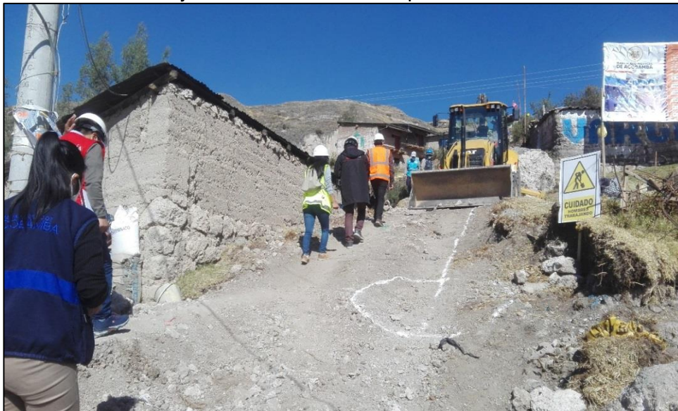
Imagen n.° 8 Trayecto de la obra sin contenedores para los desechos
