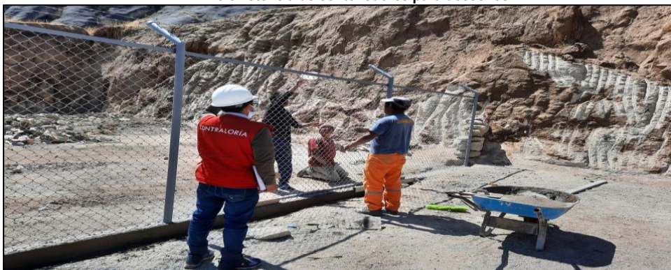
Imagen n. 21º No existencia de contenedores para desechos
