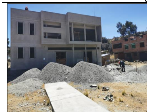
Fotografía n.º 1. Fachada de la obra donde se observó la carencia de señalización del área de trabajo
