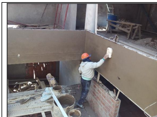
Fotografía n.º 3. Personal obrero ejecutando actividades de tarrajeo sin guantes, ni chaleco de seguridad y sin barbijos.
