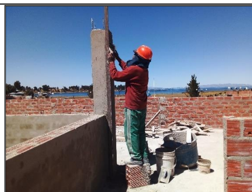
Fotografía n.º 4. Personal obrero ejecutando actividades de tarrajeo sin guantes, ni zapatos de seguridad, ni chaleco de seguridad y sin barbijos.
