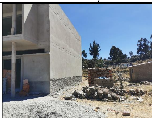
Fotografía n.º 2. Área de trabajo sin señalización.
