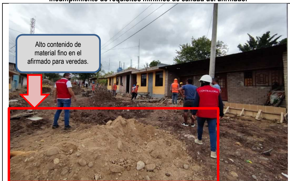
Imagen n.º 18 Incumplimiento de requisitos mínimos de calidad del afirmado.
