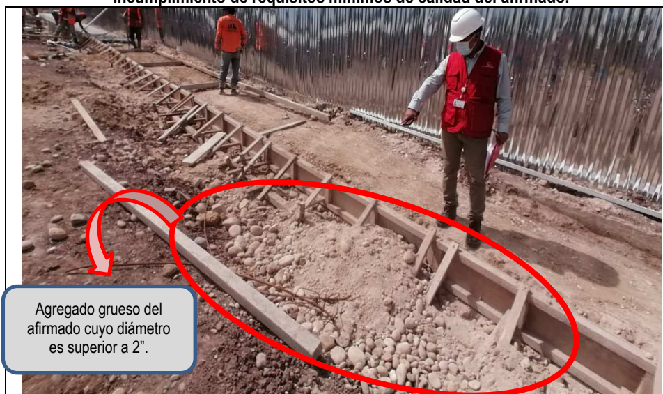
Incumplimiento de requisitos mínimos de calidad del afirmado.
