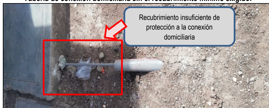
Imagen n.º 19 Tubería de conexión domiciliaria sin el recubrimiento mínimo exigido.
