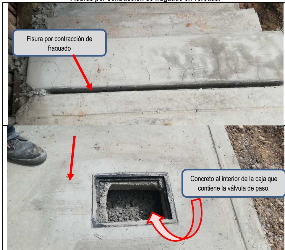
Imagen n.º 22 Fisuras por contracción de fraguado en veredas.
