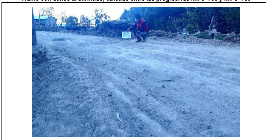
Tramo con daños al afirmado, ubicado entre las progresivas km 8+700 y km 8+780
