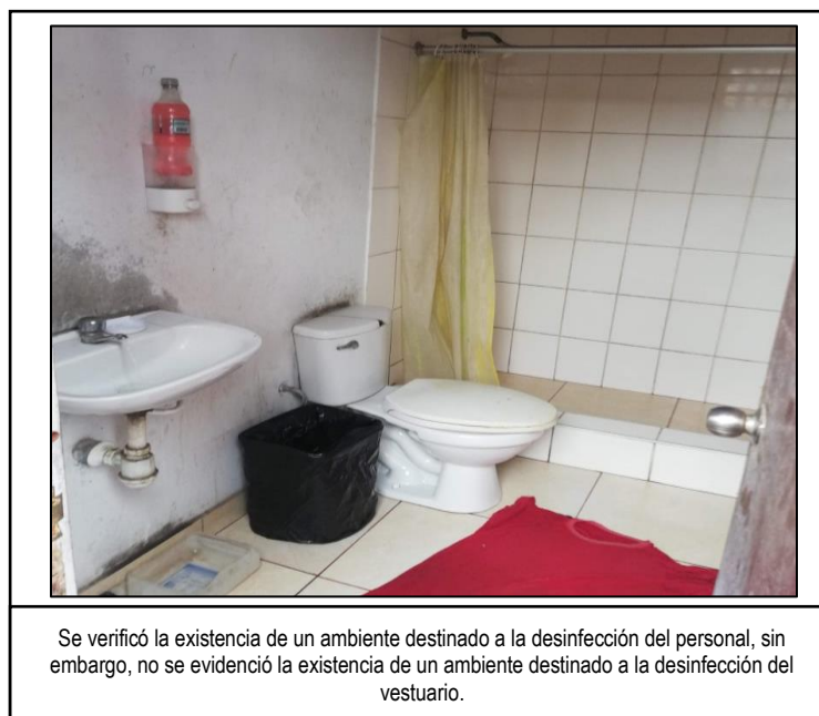
Imagen n.º 19 Ambiente destinado a la desinfección del personal de limpieza
