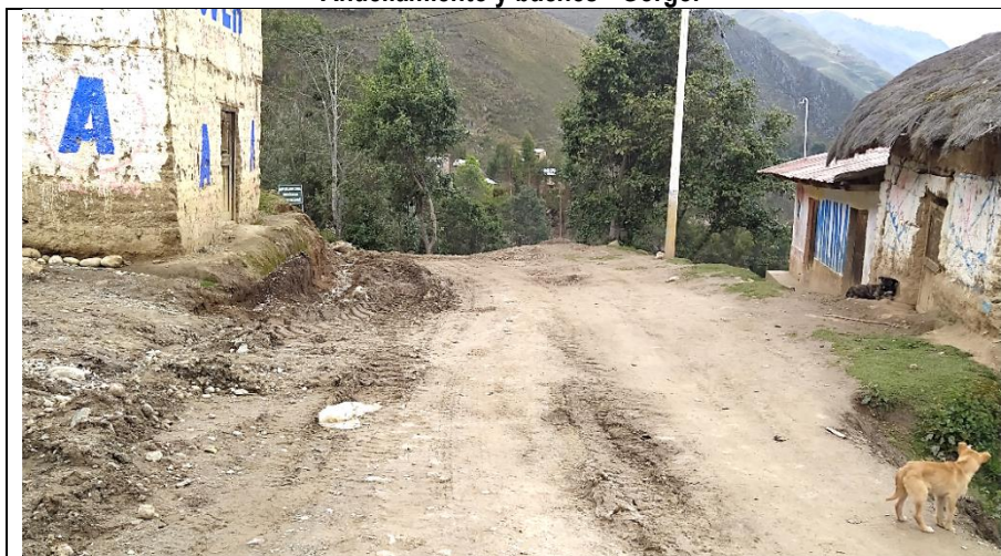
Fotografía n.º 20: Progresiva 00+520 - Se observan deformaciones en la capa de rodadura, ahuellamiento y baches, además no se observa conformación de cunetas, y se aprecia material acumulado al lado derecho de la vía.
