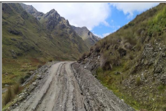
Fotografía 16: Progresiva 9+300 - Continúa la deformación de la capa de rodadura - se aprecia ahuellamiento pronunciado, predominancia de material fino saturado, asimismo no se observa conformación de cunetas.
