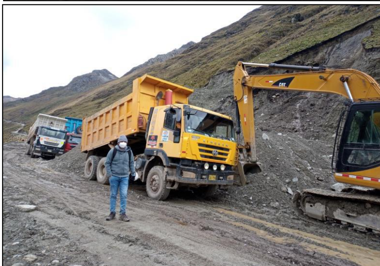
Fotografía 6,9: Vista una posible deficiencia en la compactación o un incorrecto proceso constructivo, del km 12+00 al km 13 + 00, donde se encontró presencia de maquinaria pesada.
