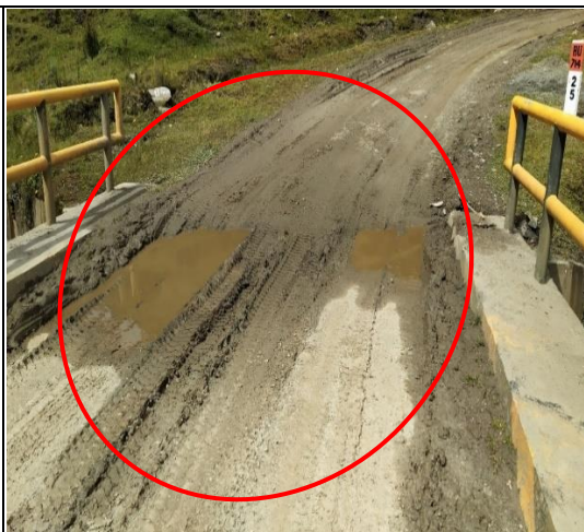
Fotografía 6: Progresiva 4+990 - Se aprecia deformación de la capa de rodadura - ahuellamiento pronunciado y baches, además de empozamiento de agua en las deformaciones sobre el puente y continúa después de pasarlo.
