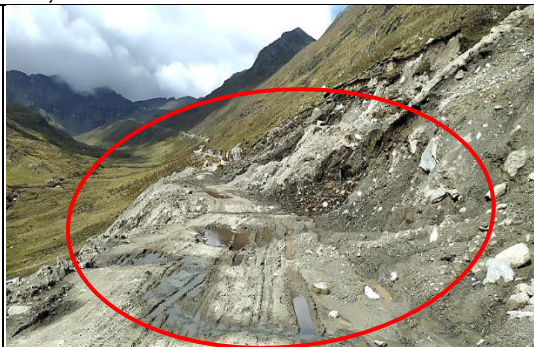
Fotografía 18: Progresiva 12+600 - Continúa la deformación de la capa de rodadura - se aprecia ahuellamiento pronunciado y empozamiento de agua en las deformaciones de la capa, no se observa conformación de cunetas; el ahuellamiento persiste aproximadamente 500 metros más.
