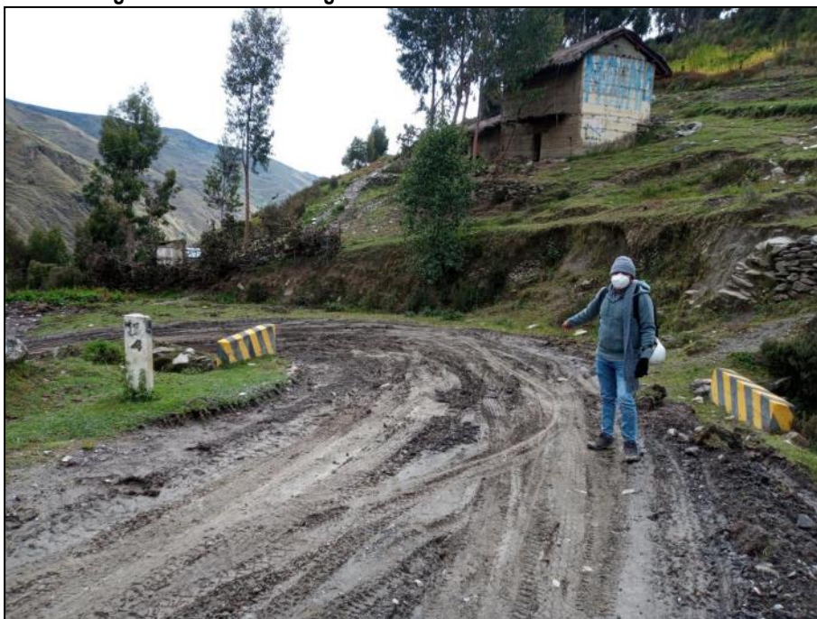
Fotografía 3; se evidencia una posible deficiencia en la compactación o un incorrecto proceso constructivo.
