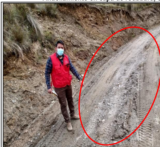
Fotografía 7: Progresiva 5+680 - Continúa la deformación de la capa de rodadura - se aprecia ahuellamiento y material segregado, así como material desplazado a los lados de la vía; puede observarse además que la cuneta está colmatada casi en un 100% de su capacidad.
