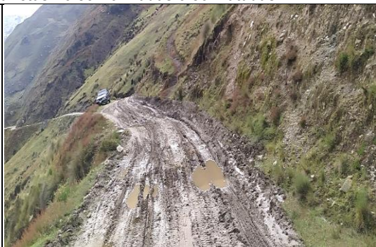
Fotografía 14: Progresiva 7+750 - Continúa la deformación de la capa de rodadura - se aprecia ahuellamiento pronunciado y empozamiento de agua en las deformaciones de la capa, asimismo no se observa conformación de cunetas.
