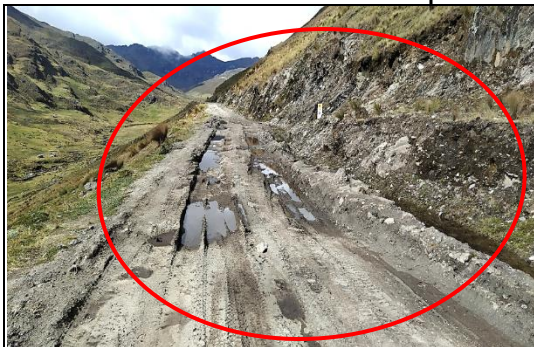
Fotografía 17: Progresiva 11+500 - Continúa la deformación de la capa de rodadura - se aprecia ahuellamiento pronunciado y empozamiento de agua en las deformaciones de la capa. Asimismo no se observa conformación de cunetas o las cunetas están colmatadas.
