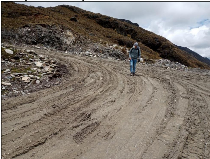
Fotografía 9; Vista una posible deficiencia en la compactación o un incorrecto proceso constructivo, en las curvas de volteo del km 17+00.
