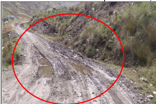
Fotografía 15: Progresiva 8+100 - Continúa la deformación de la capa de rodadura - se aprecia ahuellamiento pronunciado y empozamiento de agua en las deformaciones de la capa, asimismo no se observa conformación de cunetas.
