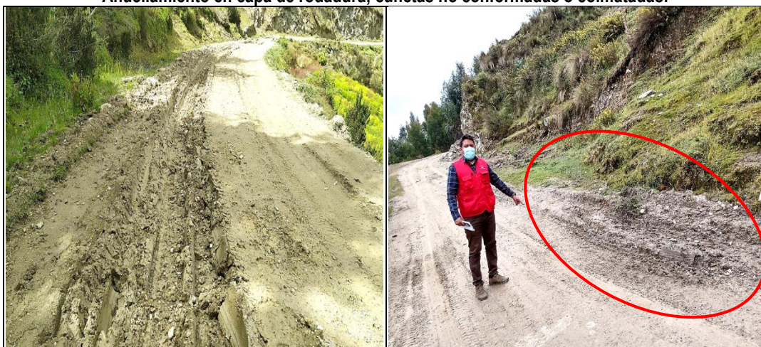
Fotografía 3: Progresiva 3+600 - Continúa la deformación de la capa de rodadura - ahuellamiento pronunciado, no se puede apreciar material granular en la conformación de la capa de rodadura, se observa material fino saturado. Se observa cunetas colmatadas, y con vegetación.
