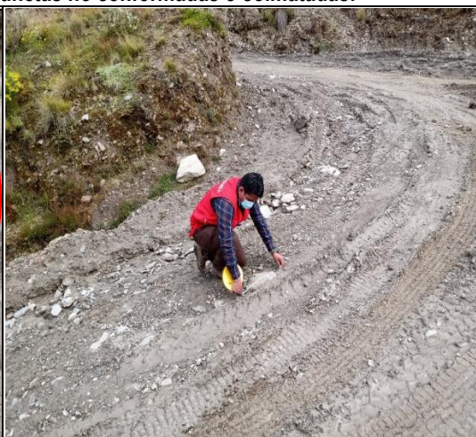
Fotografía 8: Progresiva 5+950 - Continúa la deformación de la capa de rodadura - se aprecia ahuellamiento y material segregado, así como piedras grandes utilizadas para la conformación de la capa de rodadura, de la toma de medidas se obtuvo que las piedras grandes en promedio tenían 10" de diámetro.
