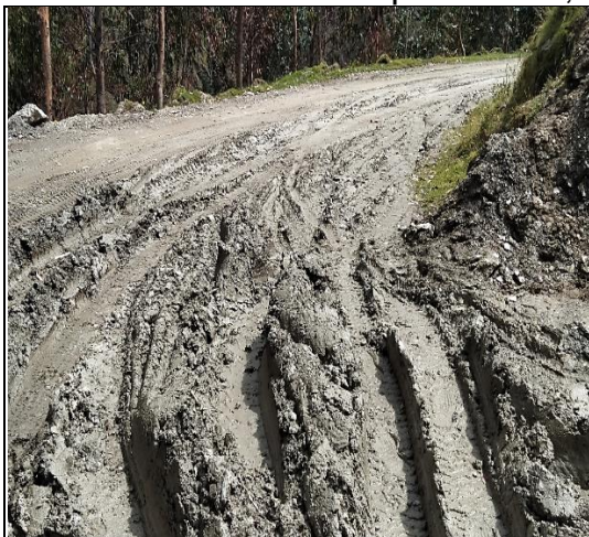
Fotografía 5: Progresiva 3+900 - Continúa la deformación de la capa de rodadura - ahuellamiento pronunciado, no se puede apreciar material granular en la conformación de la capa de rodadura, se observa material fino saturado y formación de lodo
