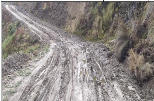
Fotografía 13: Progresiva 7+600 - Continúa la deformación de la capa de rodadura - se aprecia ahuellamiento pronunciado y empozamiento de agua en las deformaciones de la capa, asimismo no se observa conformación de cunetas.
