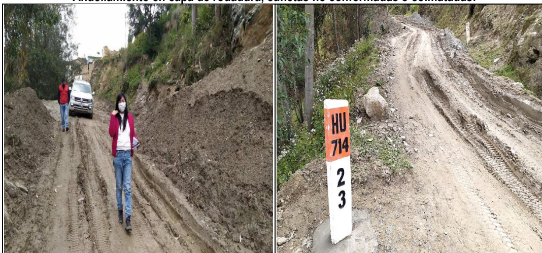
Fotografía 1: Progresiva 2+900 - Se observa deformaciones en la capa de rodadura - ahuellamiento pronunciado, no se puede apreciar material granular en la conformación de la capa de rodadura. No se observa conformación de cunetas.
