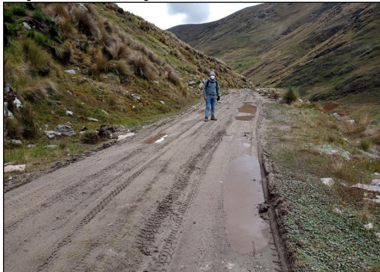
Fotografía 5,6,7; Vista una posible deficiencia en la compactación o un incorrecto proceso constructivo, del km 07+00 al km 12+00.
