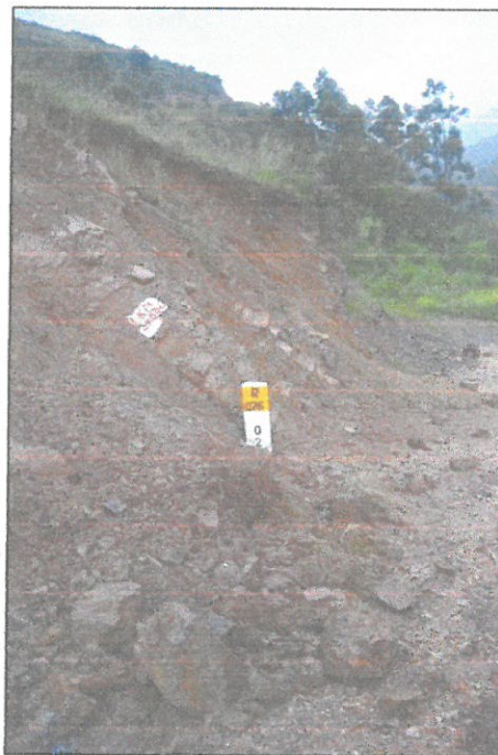
Derumbe en el kilómetro 2+000
