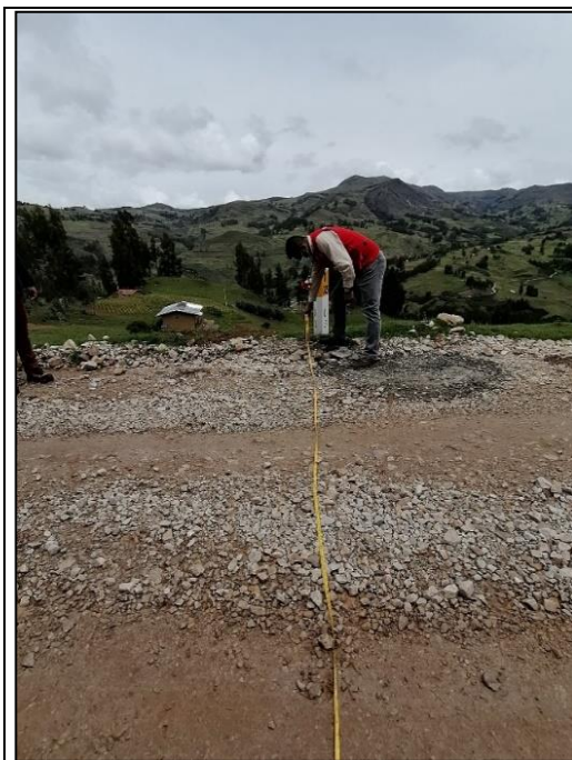
Fotografía n.º 5: Disgregamiento de capa de afirmado en la progresiva 3+500
