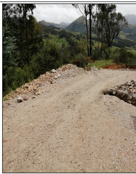
Fotografía n.º 6: Disgregamiento de material y reducción del ancho de calzada en la progresiva 3+900
