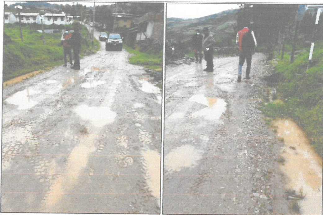
Camino deteriorado con presencia de ahuellamientos desde aproximadamente del kilómetro 2+000 hasta el inicio del kilómetro 0+250
