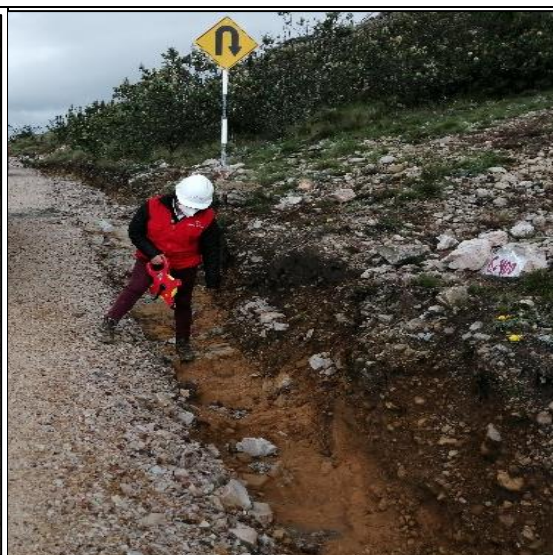
Fotografía n.° 2: Progresiva 5+000 Cuneta colmatada con material suelto.
