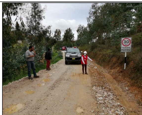
Fotografía n.º 4: Cunetas con material suelto, rocas pequeñas y vegetación en la progresiva 1+800 al 1+900.
