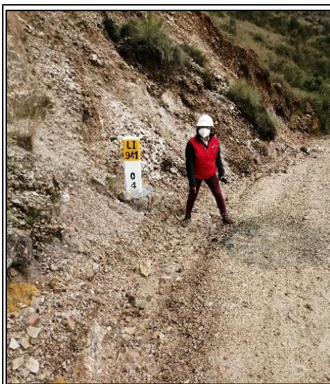
Fotografía n.° 1: Progresiva 4+000 Cuneta colmatada con material suelto.
