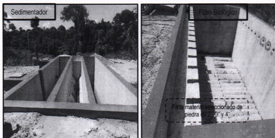
Imagen n.º 3 Planta de tratamiento de aguas residuales (PTAR)
