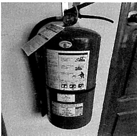
Vista fotográfica n.º 2 Implemento contra incendio (Extintor) con fecha vencida o caducada
